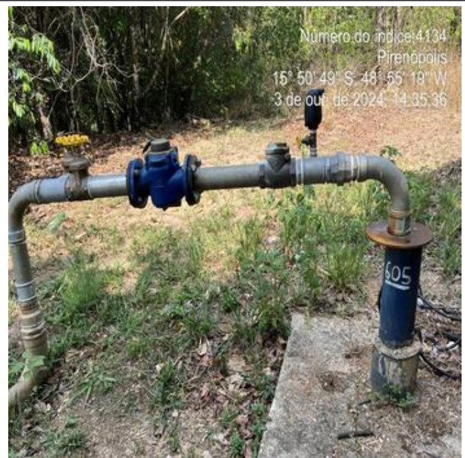
Foto 4 - Poço 605 interligado ao SAA, em operação.
