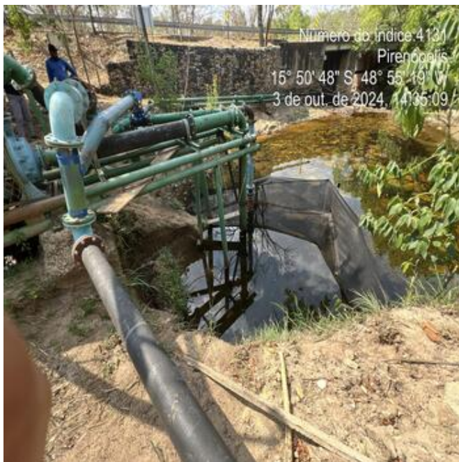
Foto 7 - Captação de água bruta Rio das Almas.
