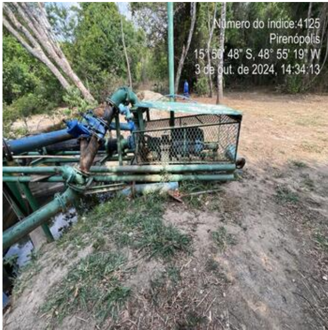
Foto 5 - Conjunto de motobomba de eixo horizontal instalado.
