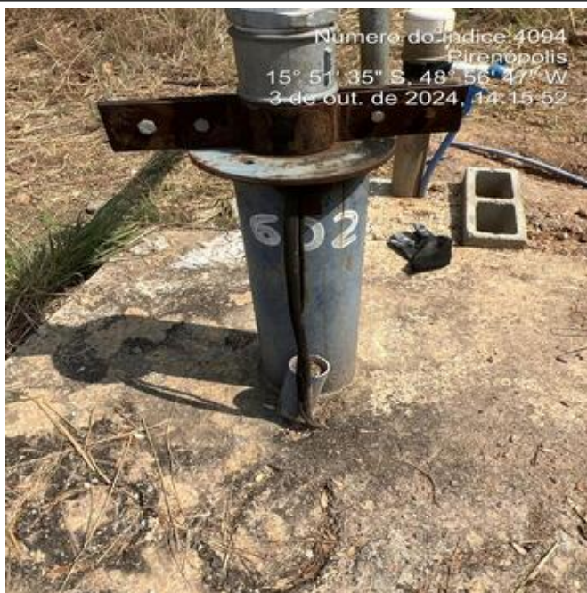
Foto 3 - Poço 602 interligado ao SAA, em operação.
