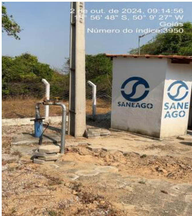
FOTO 5 - Poço PGB 187 interligado.
