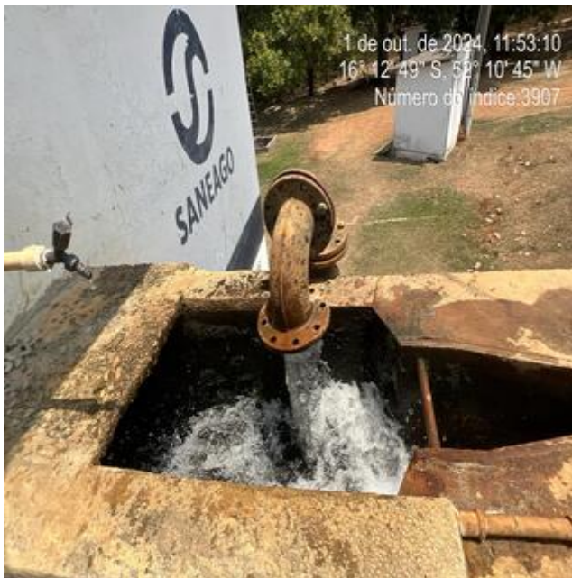
Foto 3 - Captação provisória Lago dos Buritis.
