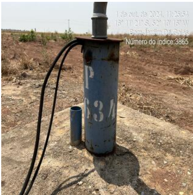
Foto 5 - Poço 634 interligado e em operação.
