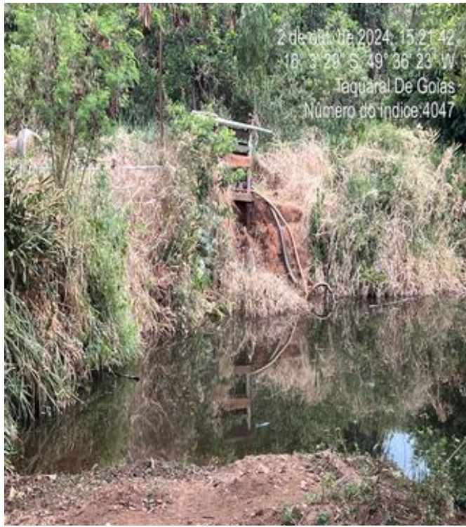
FOTO 3 - Captação no manancial à montante do lago da cidade.
