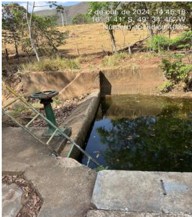
FOTO 1 - ETA/Captação superficial Córrego Boa Vista, com baixa vazão.
