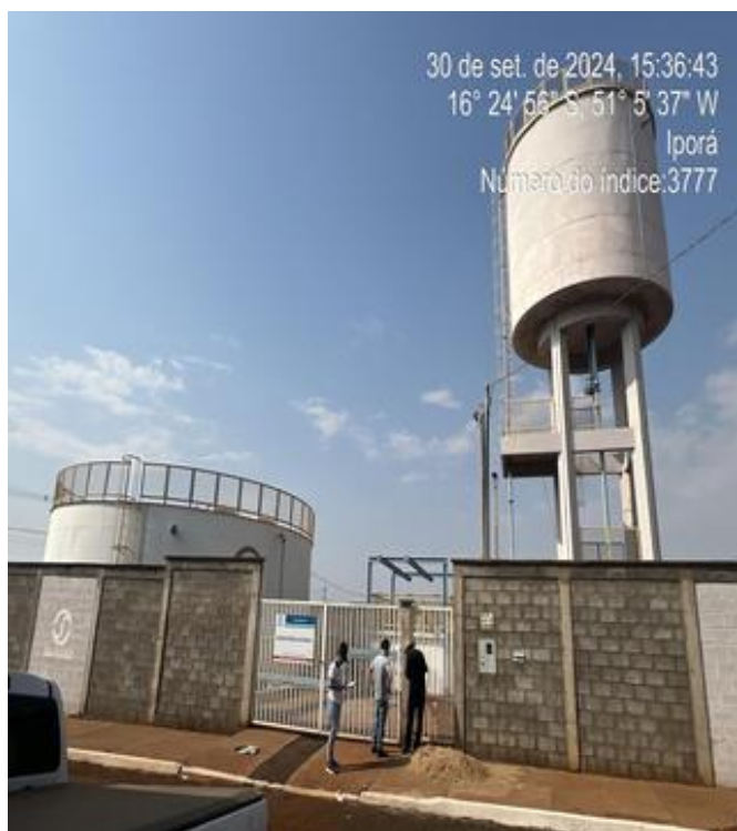
Foto 05 - RAP/500 m 3 metálico instalado e operando.
