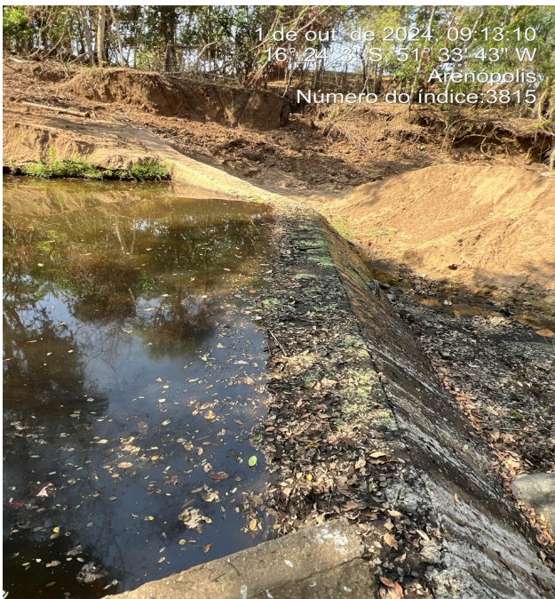
Foto 01 - Captação/Córrego Lajeado não está vertendo.
