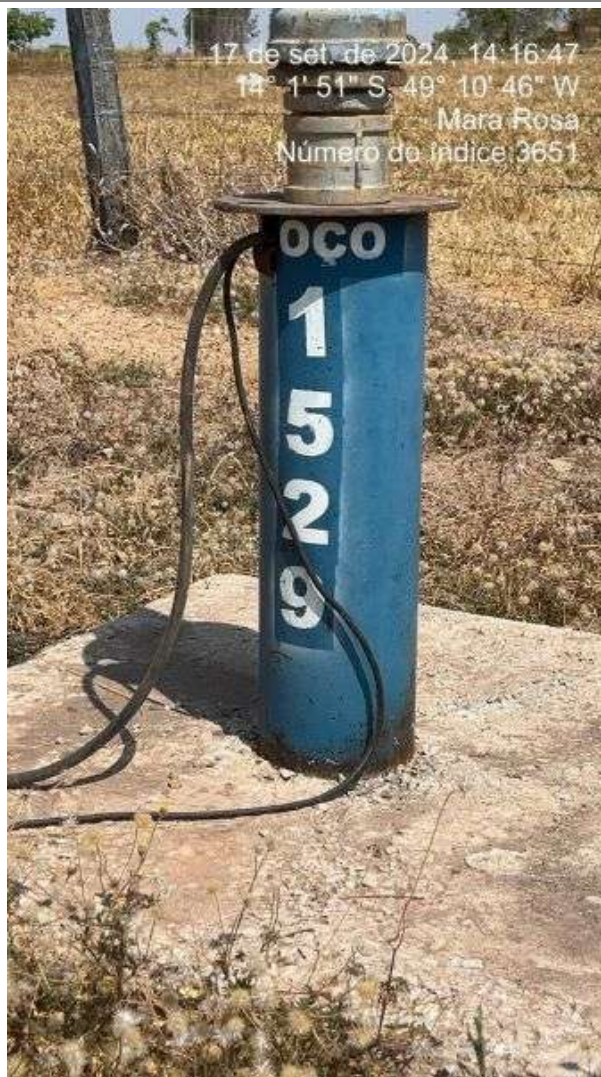
Foto 2 - Poço interligado ao sistema. P 1529.
