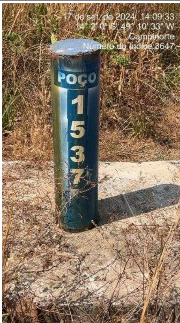
Foto 1 - Poço não interligado.
