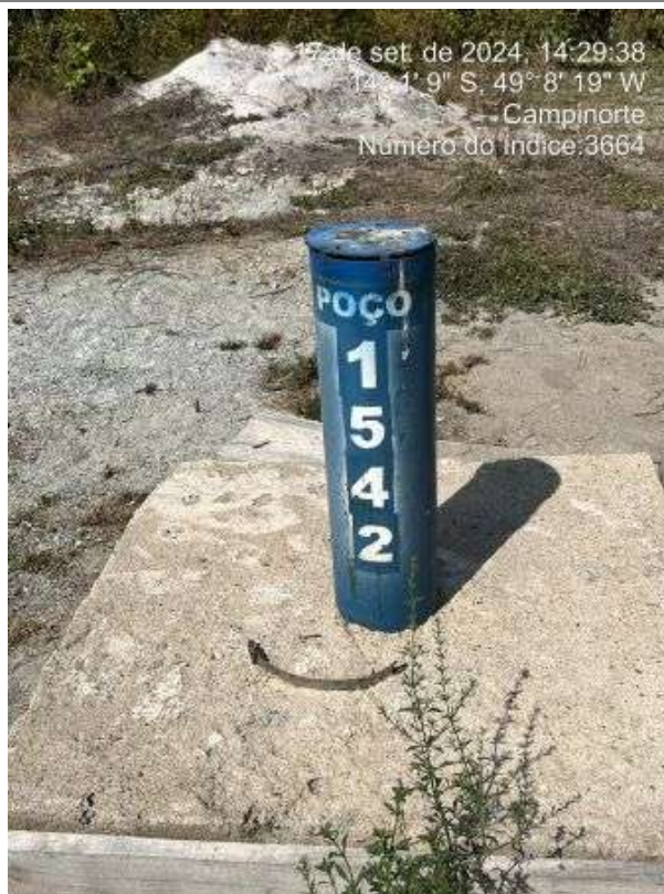
Foto 4 - Poço não interligado.
