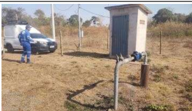
Foto 1 - Poço P-05 interligado ao sistema.
