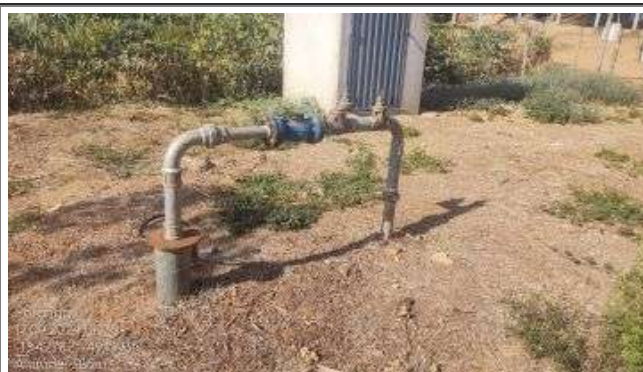
Foto 2 - Poço P-948 interligado ao sistema.
