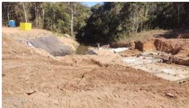
Foto 4 - Obras de construção de barragem de nível para captação de água - ribeirão Santa Rosa.
