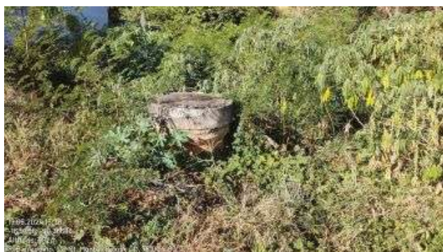
Foto 25 - Poço de Visita - Interceptor Serra Verde II
