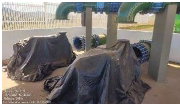
Foto 8 - Estação Elevatória de água bruta - EEAB 2.
