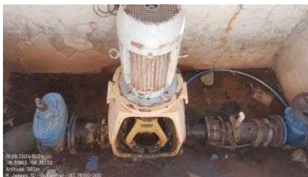
Foto 24 - Booster Montes Belos.
