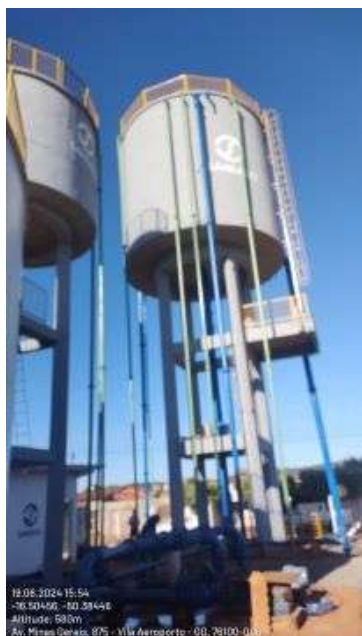
Foto 17 - REL Centro de reservação Aeroporto.
