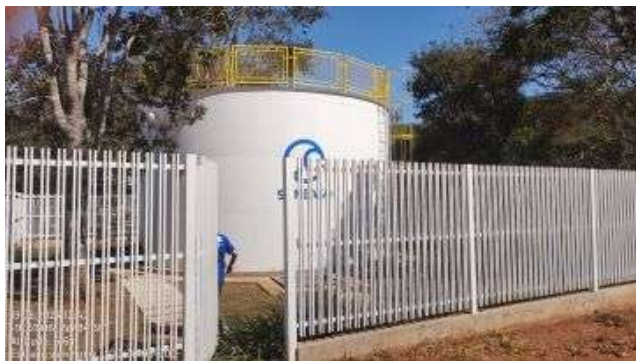
Foto 9 - Tanque de transição.
