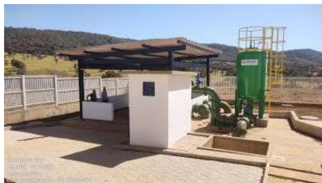
Foto 7 - Estação Elevatória de Água Bruta - EEAB 2.
