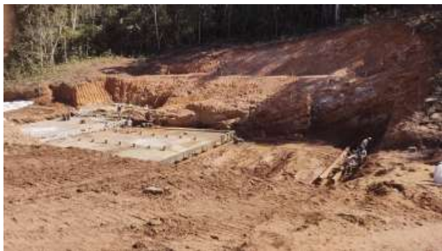
Foto 3 - Obras de construção de barragem de nível para captação de água - ribeirão Santa Rosa.
