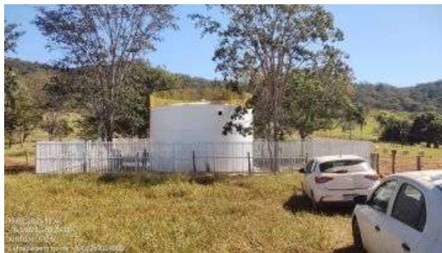
Foto 10 - Tanque de transição
