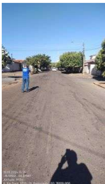
Foto 20 - Localização da adutora Santana- Aeroporto.
