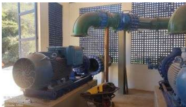
Foto 6 - Estação Elevatória de Água Bruta - EEAB 1.
