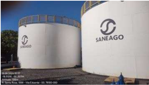
Foto 29 - Centro de Reservação Montes Belos, 2 RAP de 500 m 3 .
