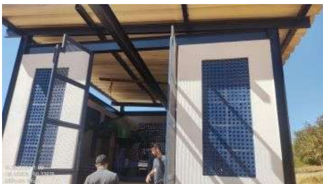
Foto 5 - Estação Elevatória de Água Bruta - EEAB 1.
