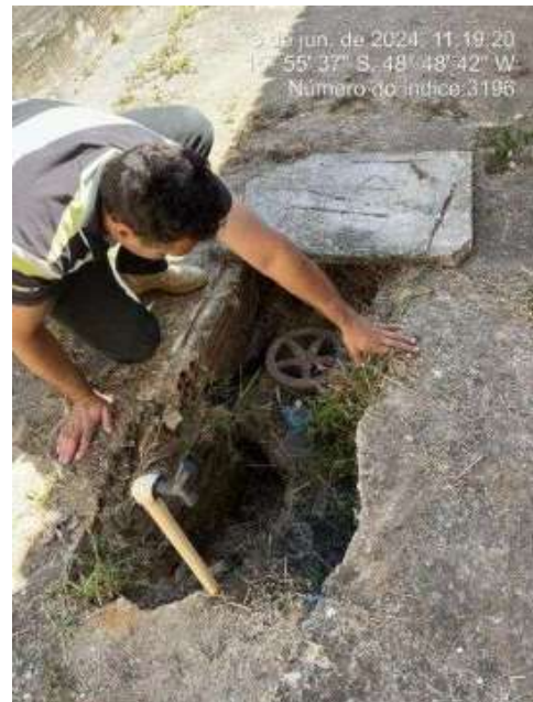
Figura 7 - Tampas das caixas de inspeção e/ou passagem inadequadas e/ou danificadas.
