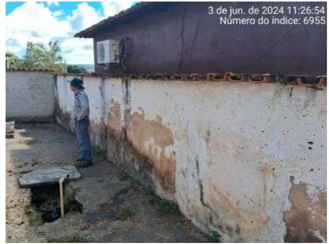
Figura 5 - Perda de pintura e de revestimento das paredes.
