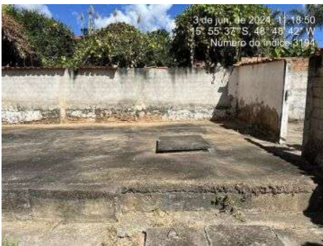
Figura 6 - Perda de pintura e de revestimento.
