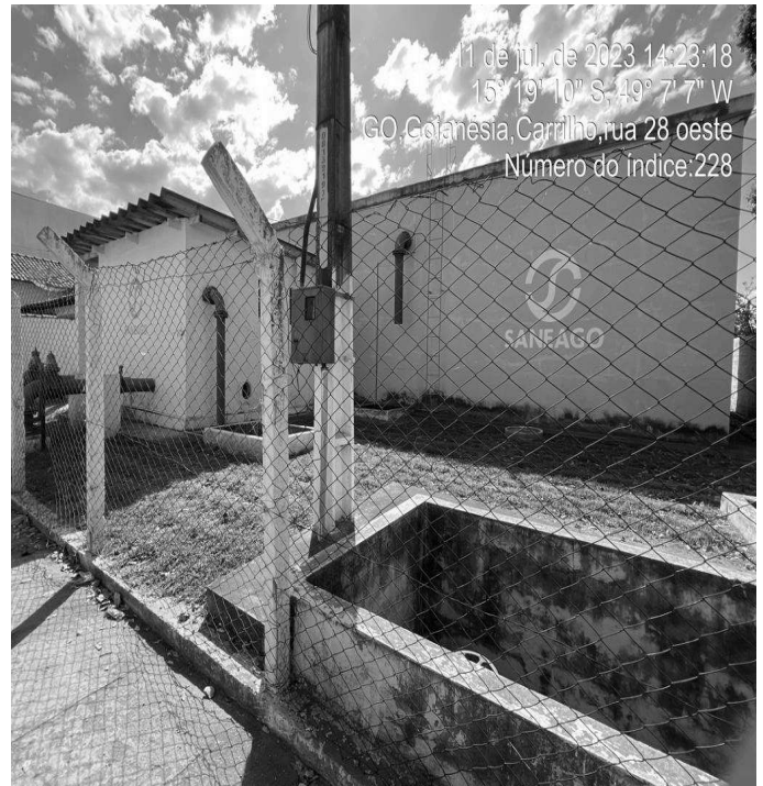
Foto 8 - RAP 300 m 3 Carrilho com ausência de grade de proteção ou tampa nas caixas de passagem.
