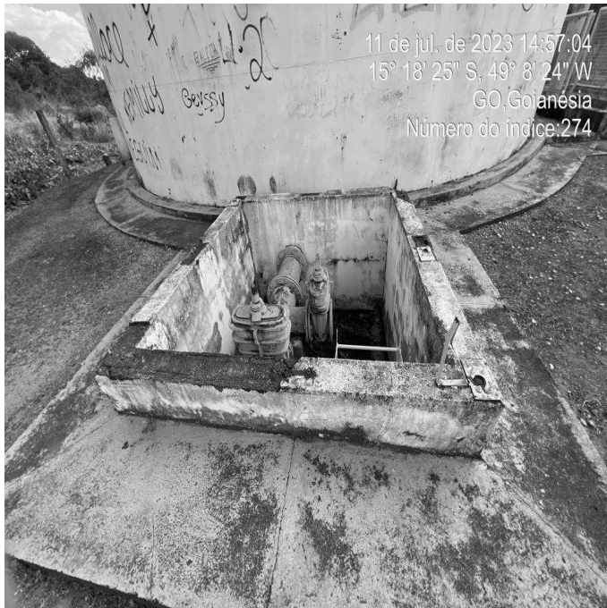
Foto 15 - RAP 500 m 3 metálico - CR Morro da Ema com ausência de grade de proteção ou tampa nas caixas de passagem.
