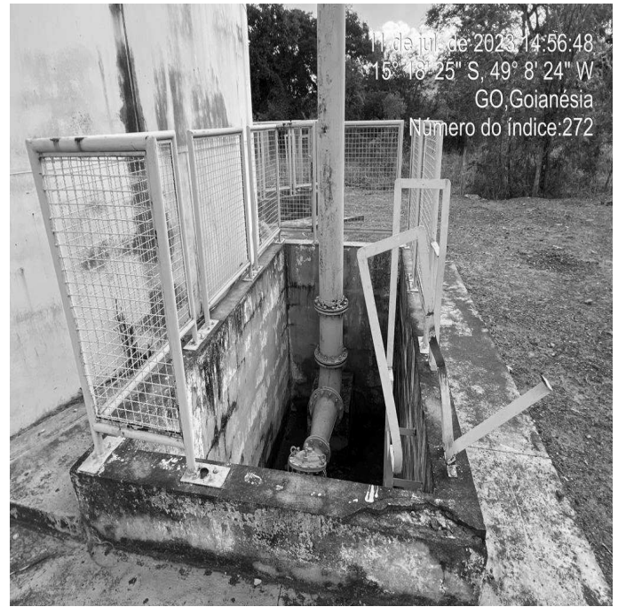
Foto 14 - C.R. Morro da Ema com ausência de grade de proteção nas caixas de passagem.
