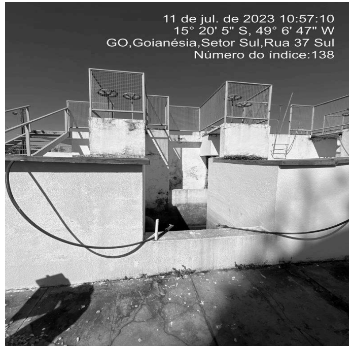
Foto 2 - Flocculadores, decantadores e filtros com pintura desgastada.
