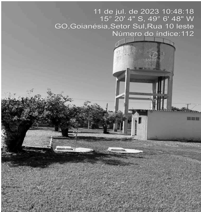
Foto 7 - REL ETA 300 m 3 com pintura desgastada e infiltração
