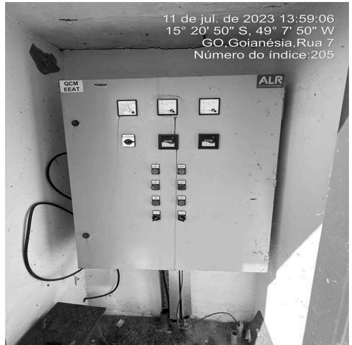
Foto 4 - Booster Carrilho: abrigo do quadro de comando sem aviso de perigo de risco.
