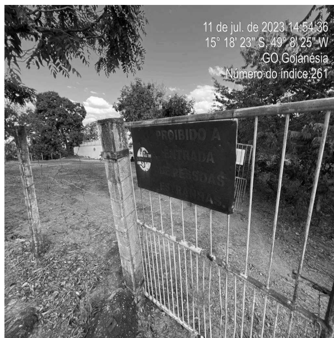
Foto 12 - CR Morro da Ema portão do CR corroído.
