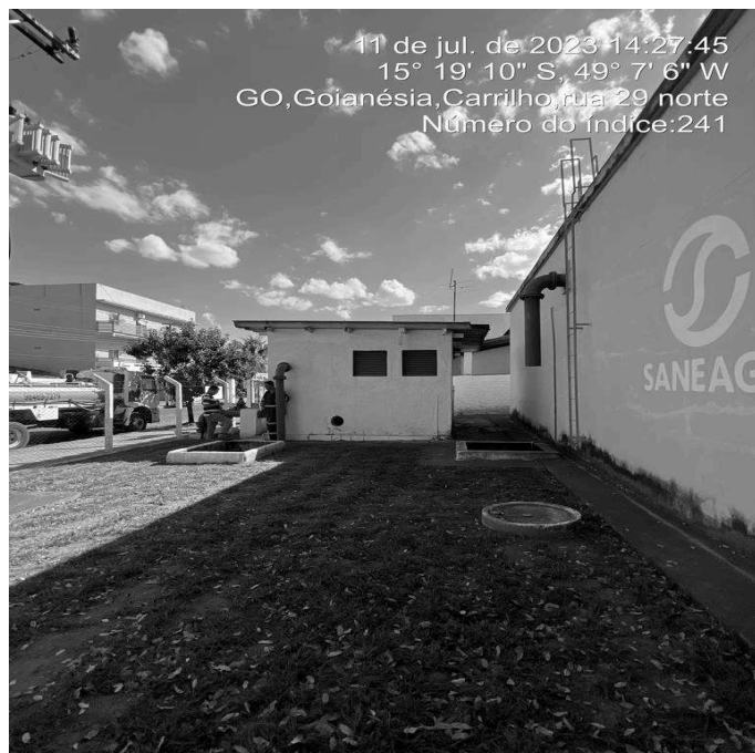
Foto 09- RAP 300 m 3 Carrilho com ausência de guarda corpo na escada de acesso ao topo.
