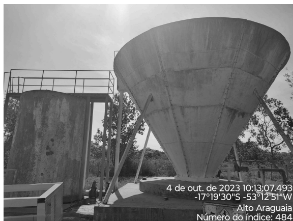
Foto 9 - Corrosão no Floco-decantador
