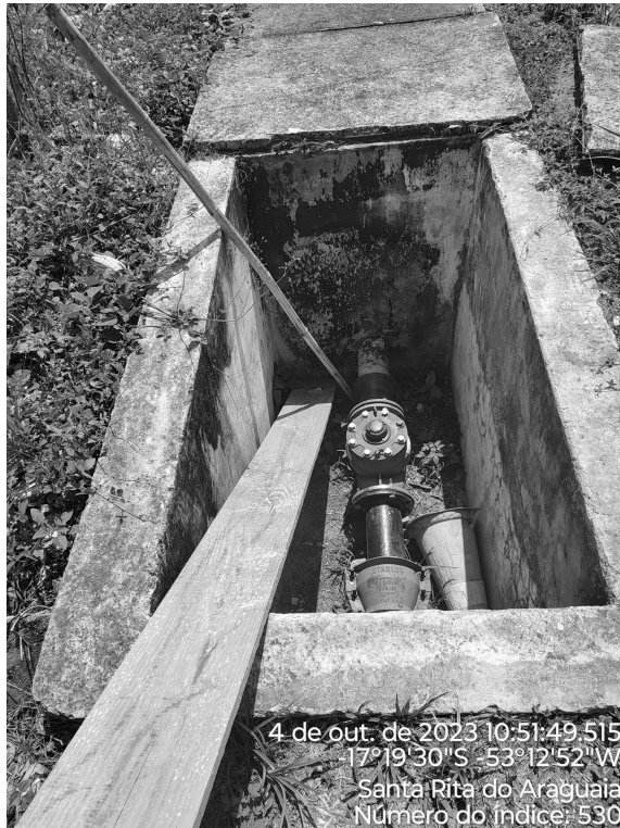
Foto 6 - Ausência de grade de proteção ou tampa na caixa de passagem do macromedidor
