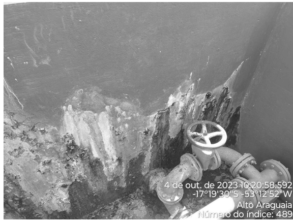
Foto 4 - Galeria dos filtros da ETA com presença de infiltração
