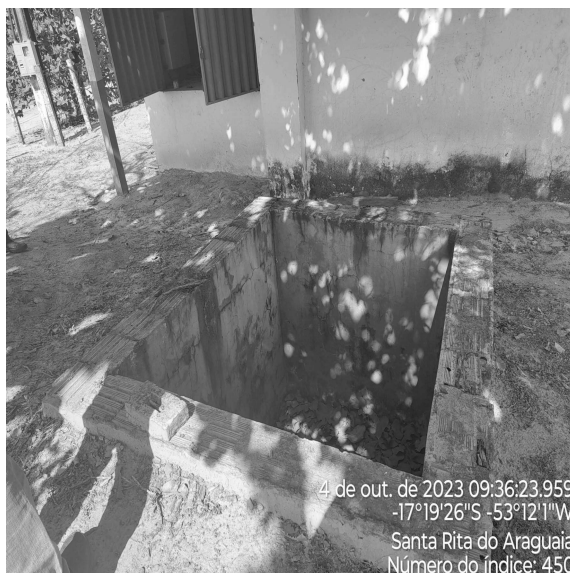
Foto 16 - Ausência de grade de proteção ou tampa na caixa de passagem no RAP 200 m 3 .
