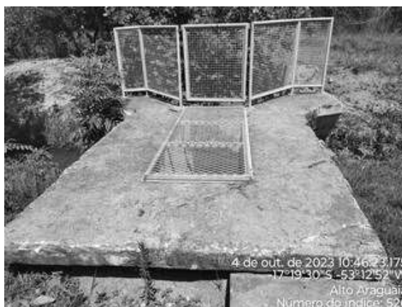
Foto 2 - Captação sem placa de identificação.
