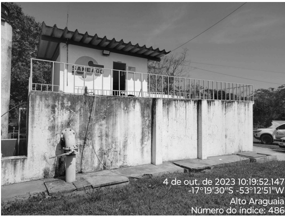
Foto 3 - ETA com edificações com pintura desgastada
