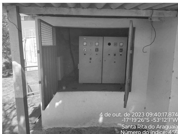
Foto 11 - Abrigo do quadro de comando da EEAT CR sem aviso de advertência
