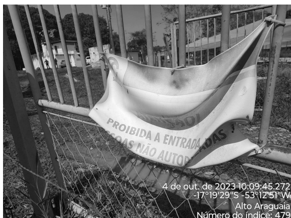
Foto 1 - Placa de identificação da ETA danificada e com ausência de identificação da captação e elevatórias.
