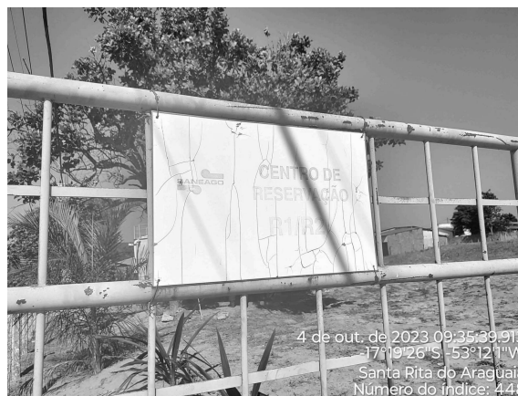
Foto 10 - Placa desgastada da EEAT CR R1/R2
