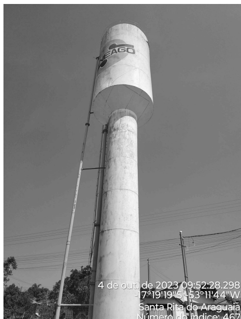
Foto 15 - REL 50 m 3 com pintura desgastada.
