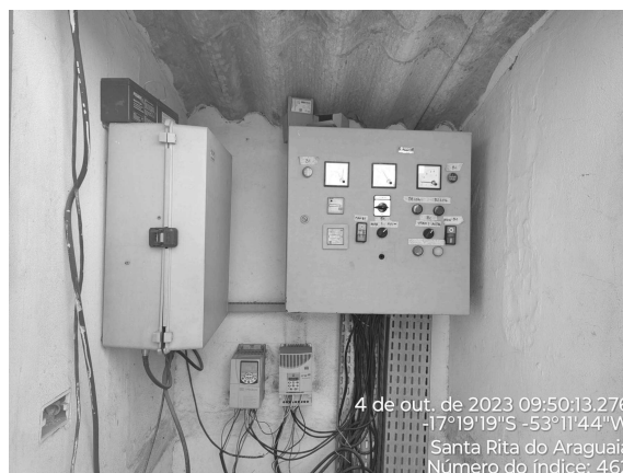
Foto 12 - Abrigo do quadro de comando da EEAT CR sem aviso de advertência da EEAT Morada do sol/Bela Vista.
