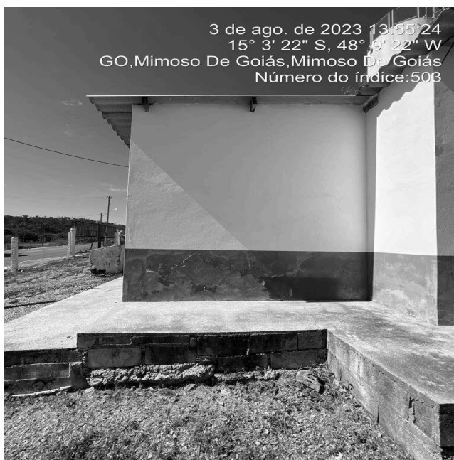
Foto 4 - Casa de química com perda de revestimento.
