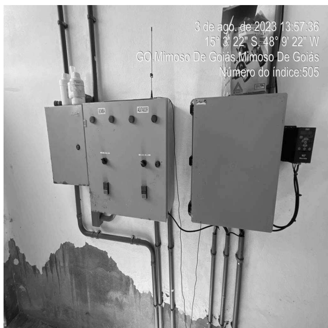
Foto 3 - Q.C. sem aviso de risco.
