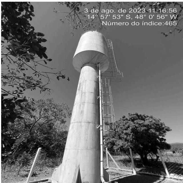
Foto 1 - Pintura desgastada do REL.
