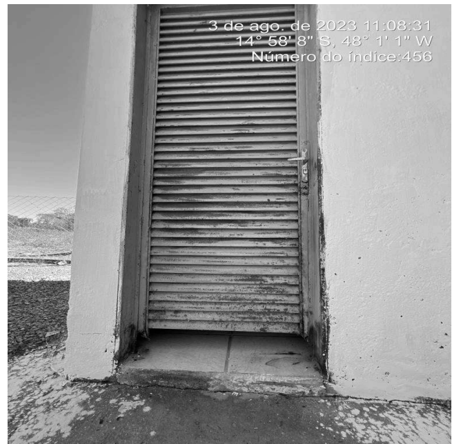
Foto 2 - Porta da casa de química enferrujada/corroída na localidade do P1.
