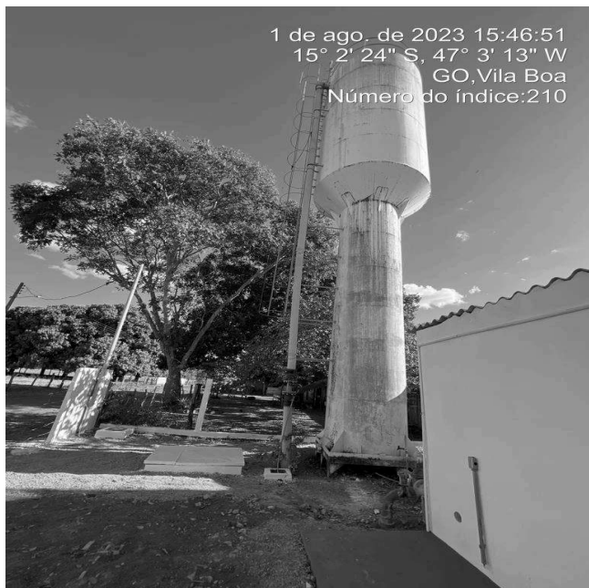
Foto 1 - Pintura do REL desgastada.
