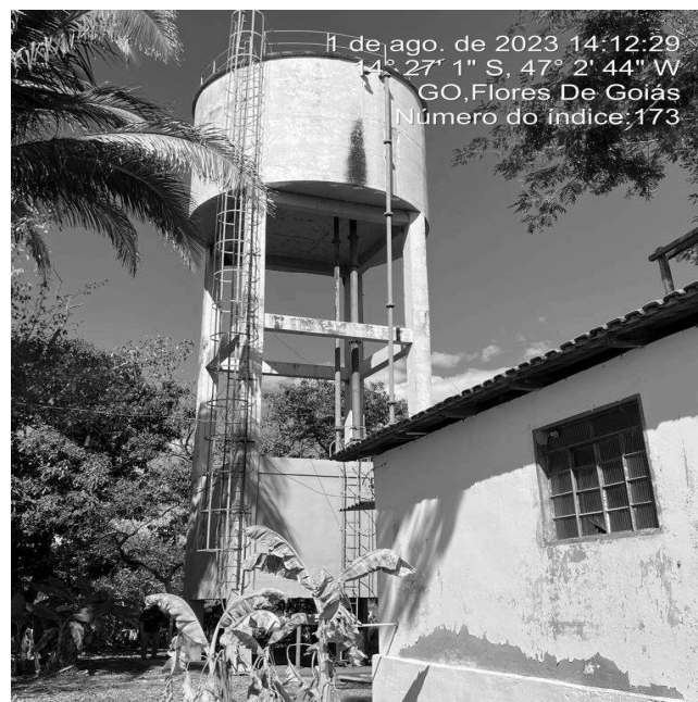
Foto 2 - Casa de química do poço com pintura desgastada.
