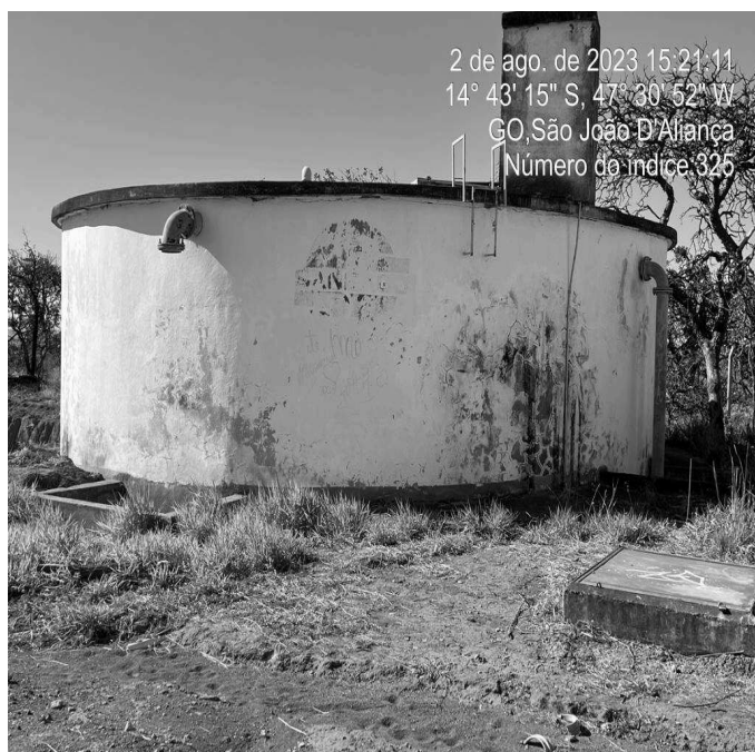
Foto 8 - C.R. St. Aeroporto RAP/300 m 3 : reservatório com infiltração.
