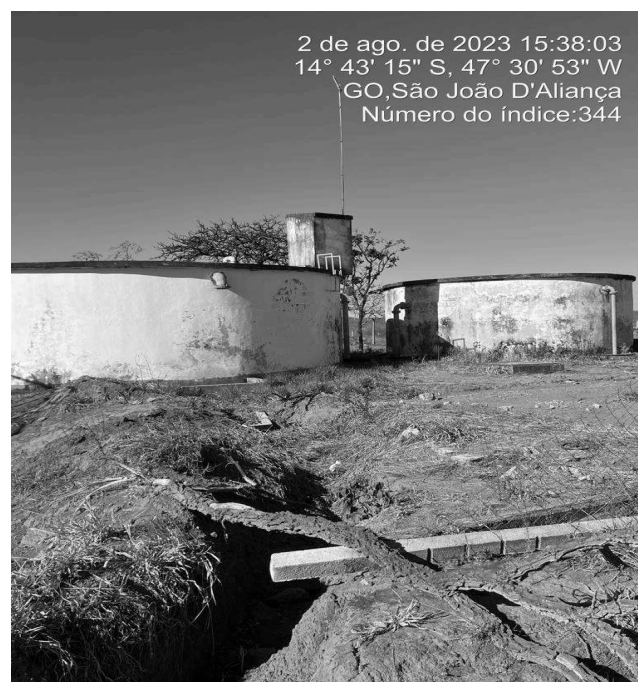
Foto 11 - C.R. St. Aeroporto com concentração de resíduos sólidos, área dos RAP's 150, 300 e 500 m 3 .
