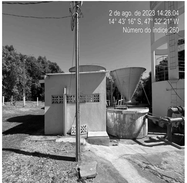
Foto 13 - ETA/RAP 11 m 3 , com tampa do reservatório corroída.
