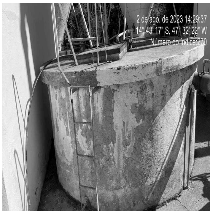
Foto 5 - RAP 11 m 3 da ETA com pintura desgastada.
