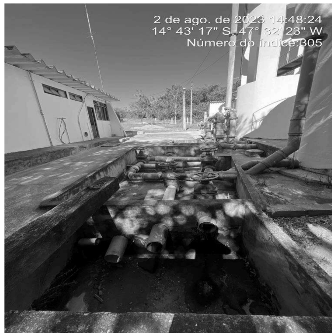
Foto 2 - ETA com ausência de grades de proteção ou tampas nas caixas de passagem.
