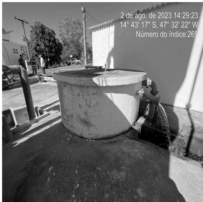
Foto 1 - ETA com ausência de grades de proteção ou tampas nas caixas de passagem.
