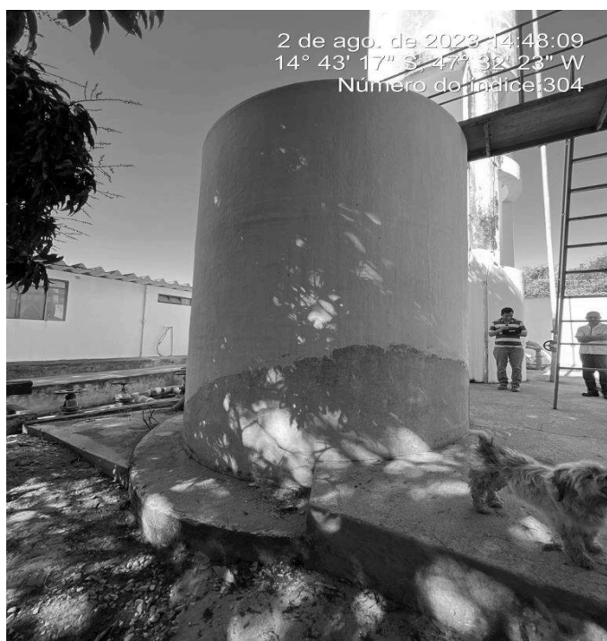
Foto 6 - ETA/reservatórios com pintura desgastada do RAP 11 m 3 , REL ETA, RAP/ETA 150 m 3 , REL 30 m 3 e RAP 300 m 3 .
