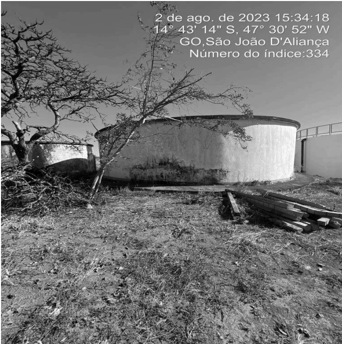
Foto 12 - C.R. St. Aeroporto com concentração de resíduos sólidos e ausência de guarda corpos na escada de acesso ao topo dos RAP's 150, 300 e 500 m 3 .
