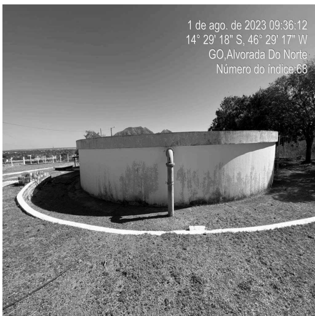
Foto 3 - Pintura desgastada no RAP 1000 m 3 .
