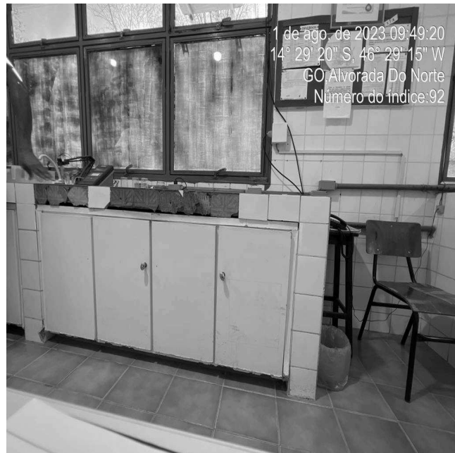
Foto 2 - Edificações do laboratório com perda de revestimento e armários deteriorados.
