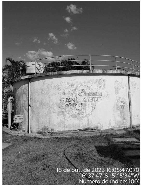
Foto 10 - RAP Vila União (escritório) com pintura desgastada.
