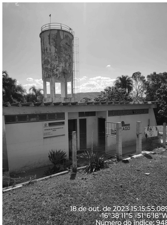
Foto 6 - Edificações da ETA com pintura desgastada.
