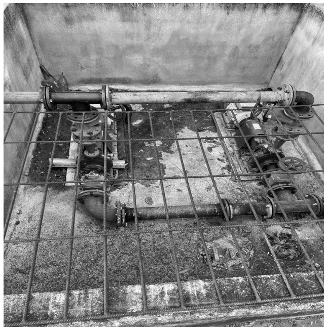
Foto 4 - Caixas de passagem sem tampa ou grade de proteção.
