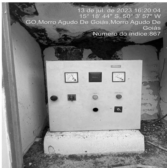
Foto 3 - EEAT/ETA Q.C. sem aviso de risco.
