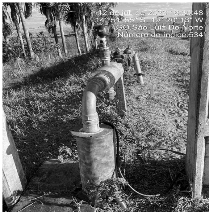
Foto 7 - Poço PGD 115 com Q.C. sem aviso de perigo de risco.
