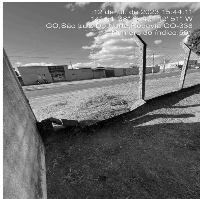
Foto 2 - ETA com cerca de proteção danificada na área urbanizada.
