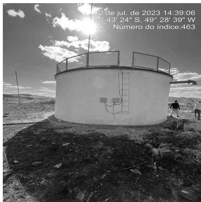
Foto 8 - RAP com ausência de guarda corpos na escada de acesso ao topo.
