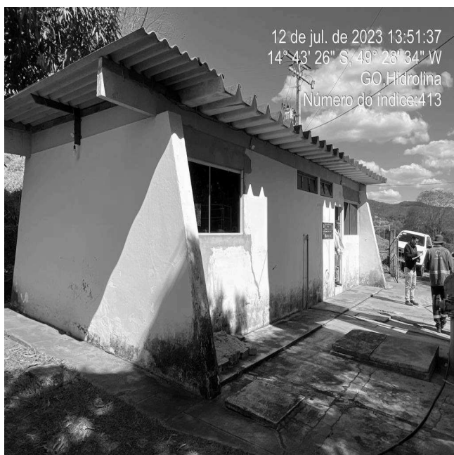
Foto 1 - ETA com pintura desgasta nas edificações.
