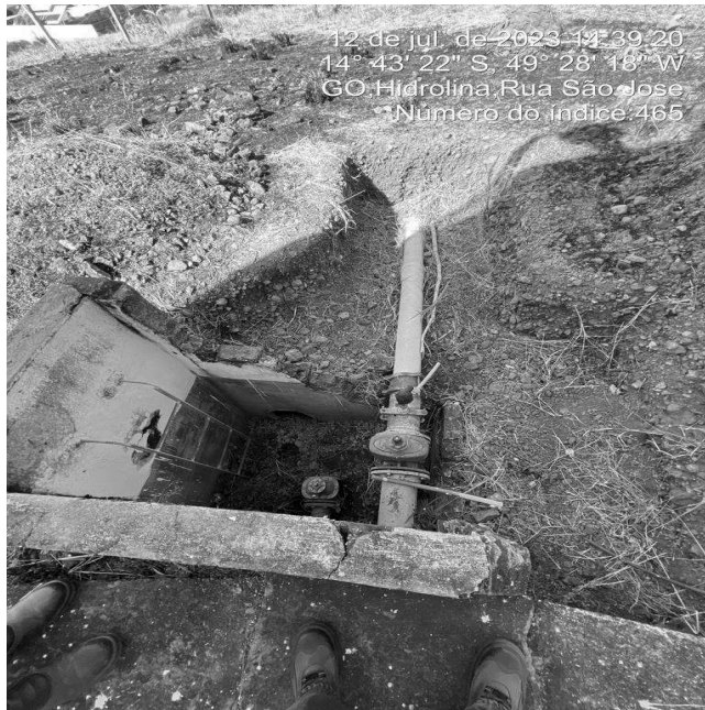
Foto 9 - RAP/com ausência de tampa ou grade de proteção na caixa de passagem da tubulação de saída do reservatório.
