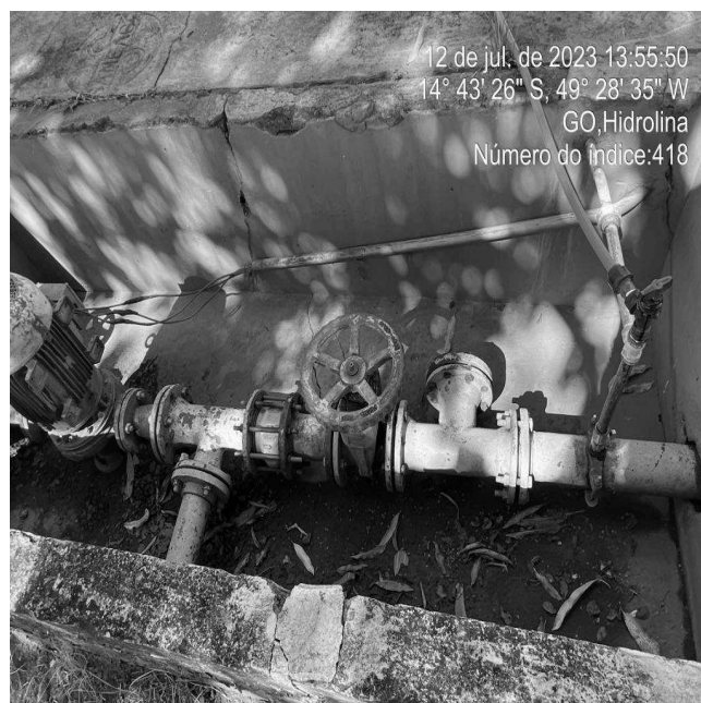
Foto 6 - Caixa de passagem sem tampa ou grade de proteção (ETA/EEAT).
