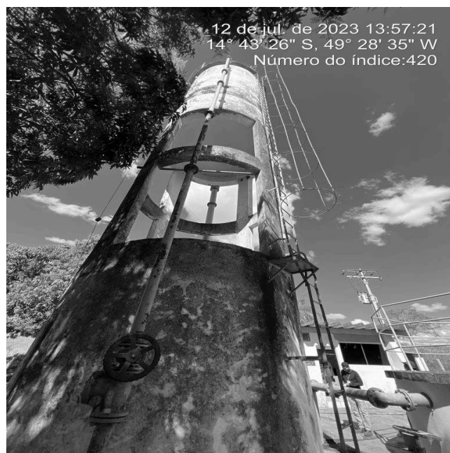
Foto 2 - REL/ETA 32 m 3 concreto e filtro russo com pintura desgastada.
