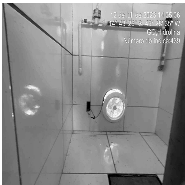
Foto 5 - Sala de cloração da ETA com exaustor danificado.
