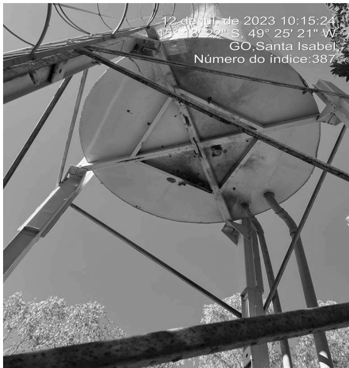
Foto 1 - REL/C.R. Santa Isabel com corrosão no fundo.
