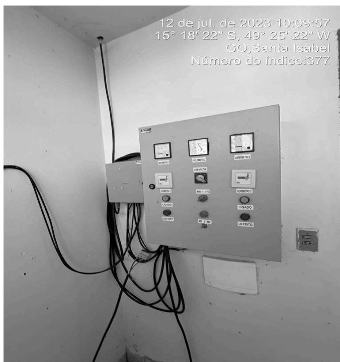
Foto 7 - Q.C. do poço PGA/781 sem aviso de risco.
