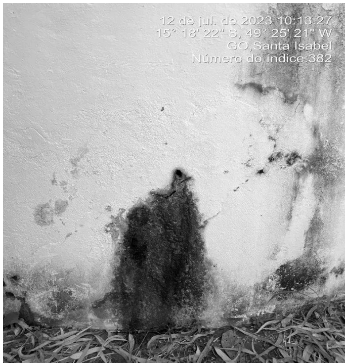
Foto 3 - RAP/C.R. Santa Isabel com infiltração.
