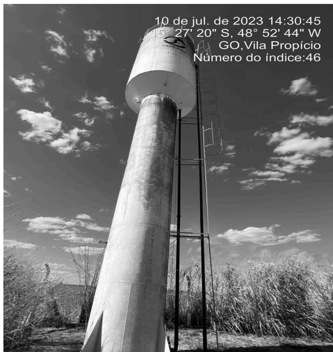
Foto 4 - REL/C.R. Vila Propício sem guarda corpo na parte inferior do REL.
