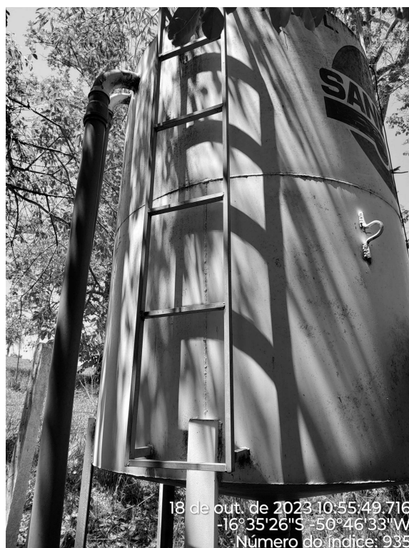
Foto 12 - REL captação com ausência de guarda-corpos.
