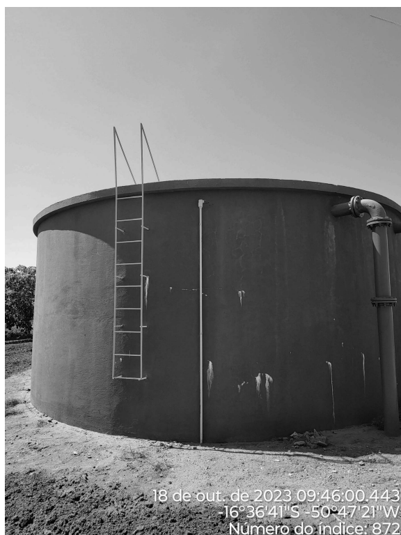
Foto 11 - RAP (CR) com ausência de guarda-corpos.
