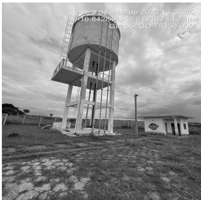
Foto 9 - REL Residencial Bandeira com pintura desgastada.
