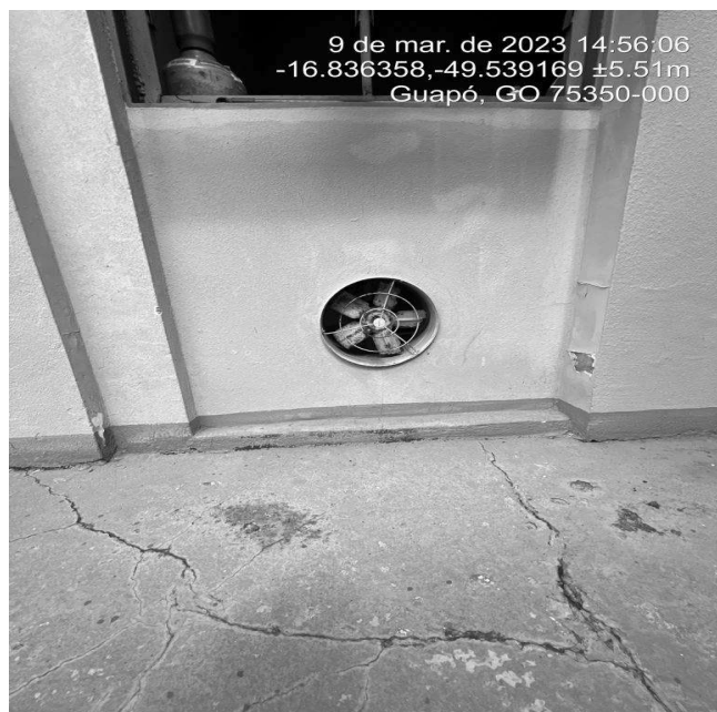
Foto 7 - ETA sala de cloração com exaustor danificado.
