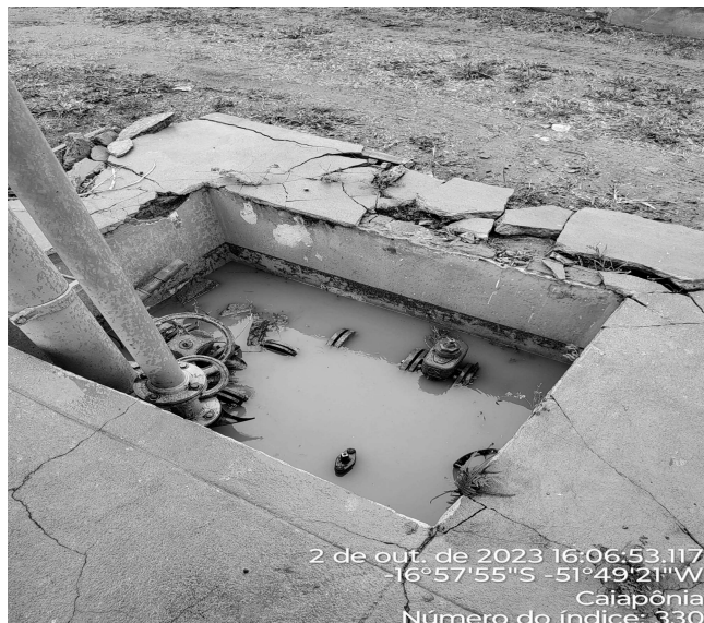
Foto 5 - Ausência de tampa ou grade de proteção nas caixas de passagem do CR.
