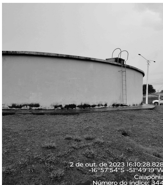
Foto 9 - Ausência de guarda-corpos no R2 (RAP 500 m 3 ) do CR.
