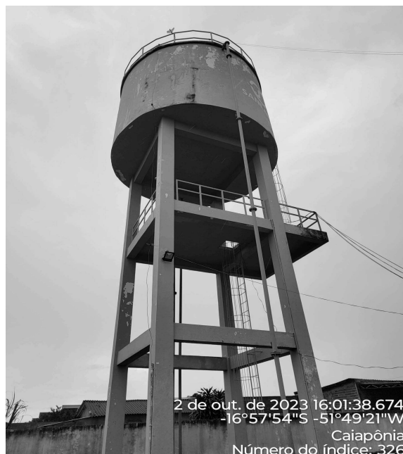
Foto 8 - Pintura desgastada no REL CR.
