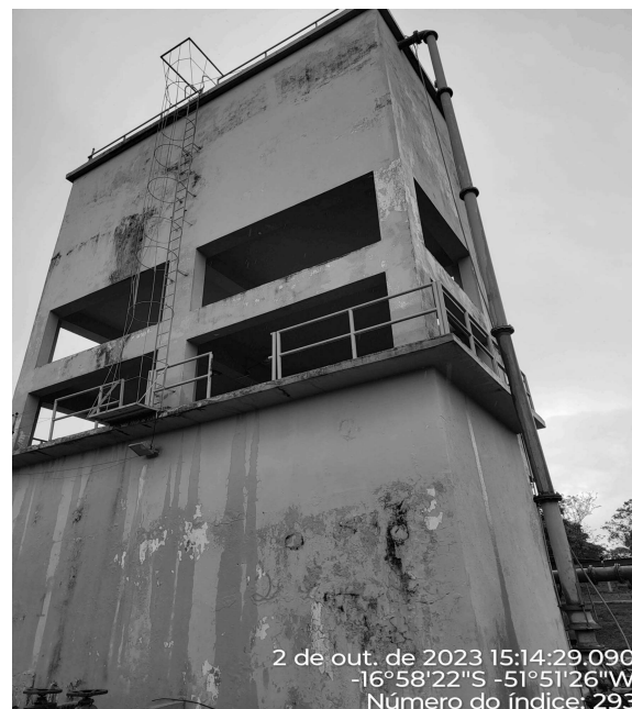
Foto 6 - Presença de infiltrações, eflorescências e pintura desgastada no REL ETA e tanque de contato.
