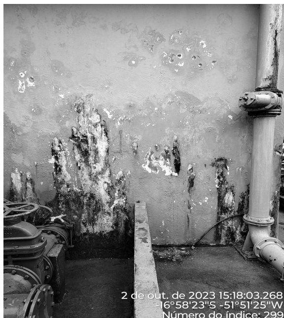
Foto 7 - Presença de infiltrações e eflorescências na parte externa da galeria dos filtros da ETA.
