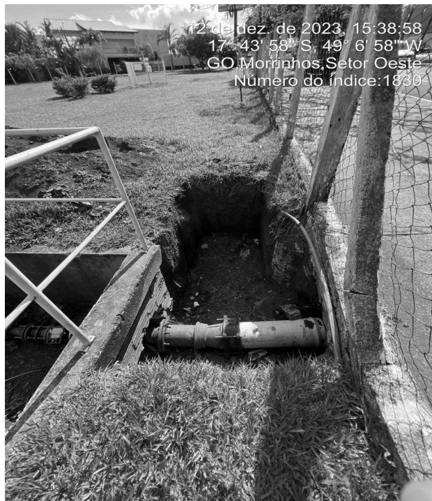
Foto 31 - ETA/Compacta, escavação realizada em manutenção, falta cobrir à escavação, colocando em risco a segurança dos colaboradores.
