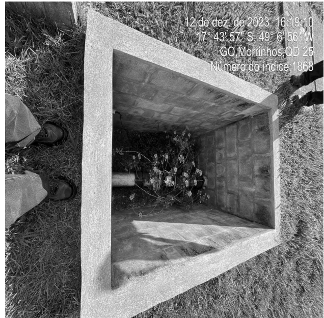
Foto 12 - C.R./Setor Aeroporto, caixas de passagem ou inspeção sem tampas ou grades de proteção adequadas.
