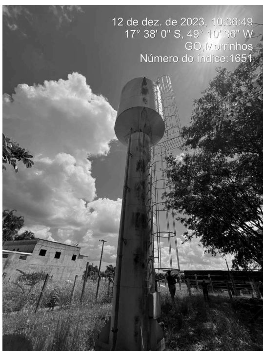
Foto 27 - REL/20 m 3 Subdistrito Rancho Alegre, corrosão e pintura desgastada.
