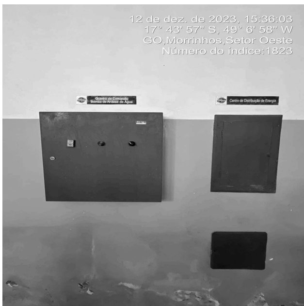
Foto 1 - EEAT/C.R Distrito, quadro de comando sem aviso de perigo nas áreas de risco.
