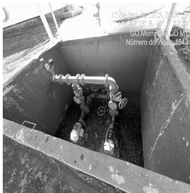
Foto 8 - Booster/Jd. Romano, caixas de passagem ou inspeção sem tampas ou grades de proteção adequadas.
