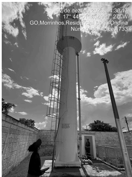
Foto 23 - ETA/REL lavagem de filtros, falta guarda corpo na escada, parte inferior.
