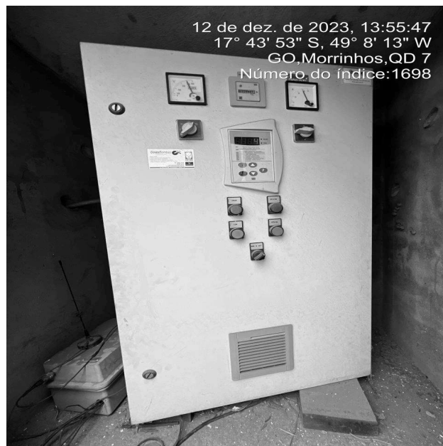
Foto 6 - Poço P2 e P3/Quadro de comando sem aviso de perigo nas áreas de risco.
