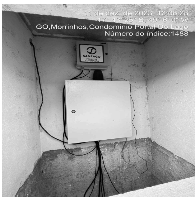
Foto 7 - REL/Portal do Lago, quadro de comando sem aviso de perigo nas áreas de risco.
