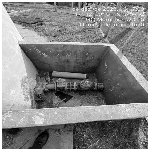
Foto 14 - C.R./Jd. Romano, caixas de passagem ou inspeção sem tampas ou grades de proteção adequadas.
