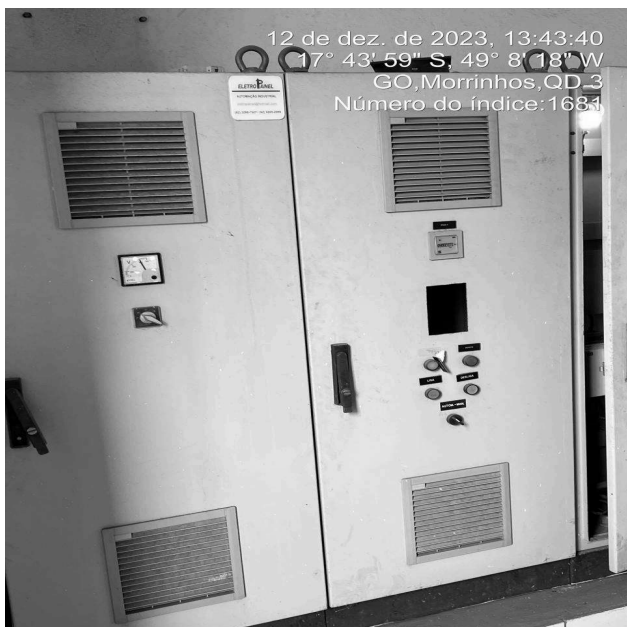
Foto 5 - EEAB/Cx. de reunião Jd. Palmares, quadro de comando sem aviso de perigo nas áreas de risco.
