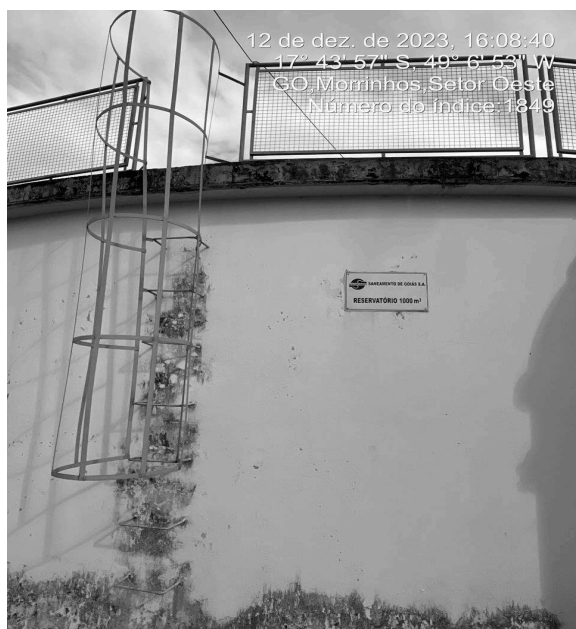
Foto 19 - RAP/Distrito com pintura desgastada.
