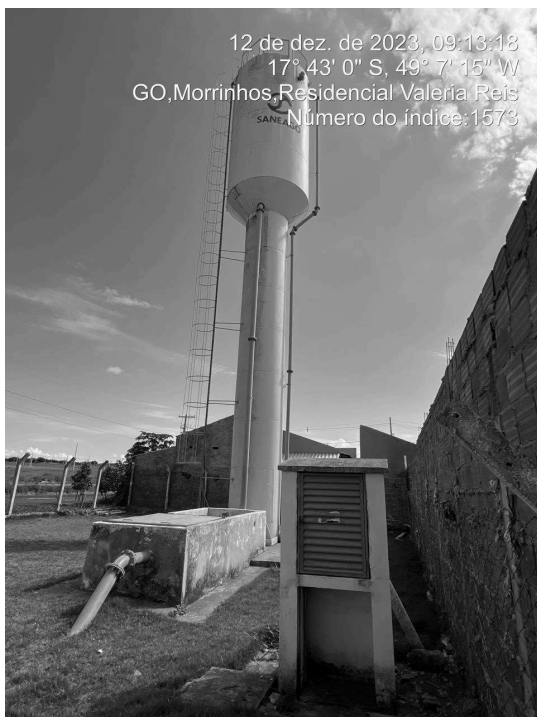
Foto 25 - REL/Valéria Reis, abrigo do macro medidor com pintura desgastada.
