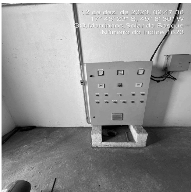
Foto 3 - EEAT/C.R. Sudoeste, quadro de comando sem aviso de perigo nas áreas de risco.
