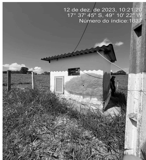
Foto 18 - Poço Rancho Alegre, pintura do abrigo do quadro de comando danificada.
