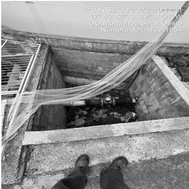
Foto 11 - C.R./Distrito, caixas de passagem ou inspeção sem tampas ou grades de proteção adequadas.
