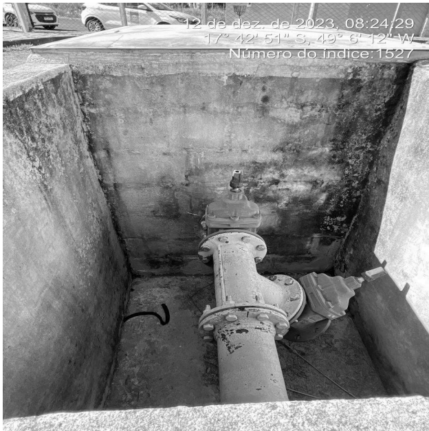
Foto 9 - Setor Sol Nascente, caixas de passagem ou inspeção sem tampas ou grades de proteção adequadas.
