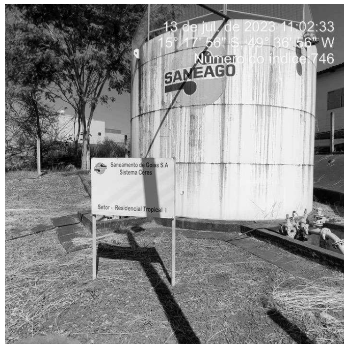
Foto 14 - RAP 100 m 3 Metálico Tropical I com pintura desgastada.
