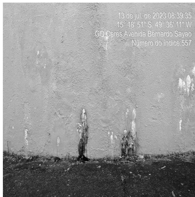
Foto 24 - RAP 500 m 3 Concreto CR Cruzeiro com infiltrações.
