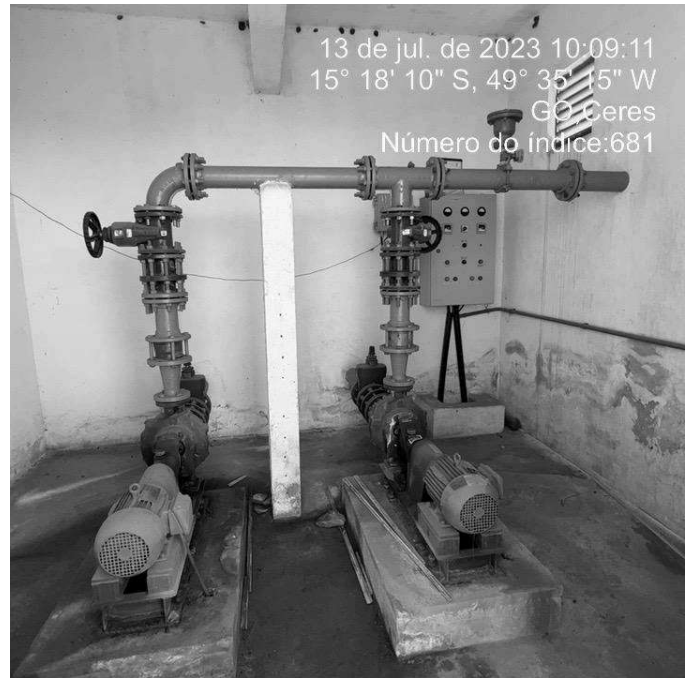
Foto 6 - EEAT Aldeia do Vale abrigo do quadro de comando sem aviso de perigo de risco.
