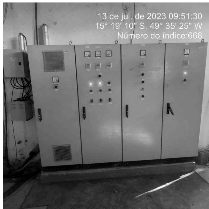
Foto 2 - EEAB/Captação Rio das Almas com quadro de comando sem aviso de perigo de risco.
