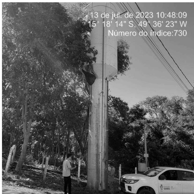
Foto 17 - REL 50 m 3 metálico Bouganville I com pintura desgastada.
