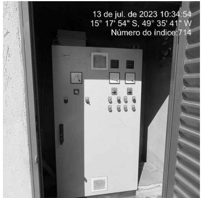
Foto 8 - Booster Petrópolis, Bouganville e Tropical com quadro de comando sem aviso de perigo de risco.
