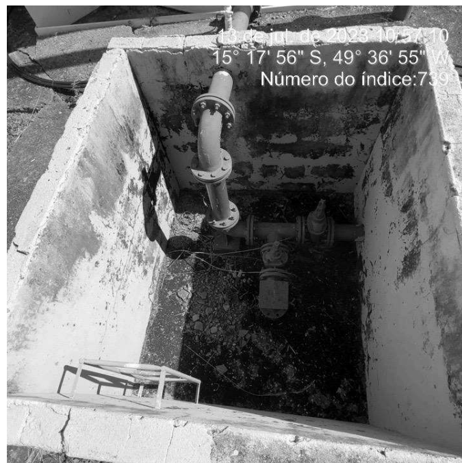
Foto 22 - REL 200 m 3 / Sara Ribeiro/concreto: Ausência de grade de proteção ou tampa nas caixas de passagem.
