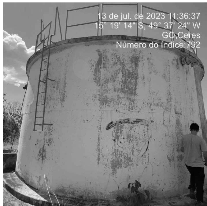
Fotos 10 - RAP 150 m 3 concreto Sorriso II: ausência de guarda corpos na escada de acesso ao topo do reservatório.
