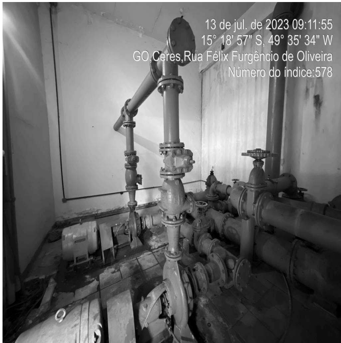
Foto 5 - EEAT ETA com pintura desgastada e infiltração na edificação ocasionada pelo RSE.
