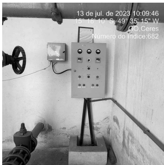
Foto 4 - EEAT Cruzeiro abrigo do quadro de comando sem aviso de perigo de risco.
