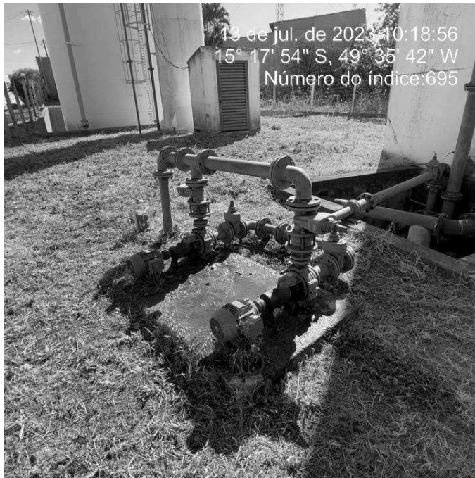
Foto 7 - EEAT/C.R. Petrópolis com presença de vazamento.
