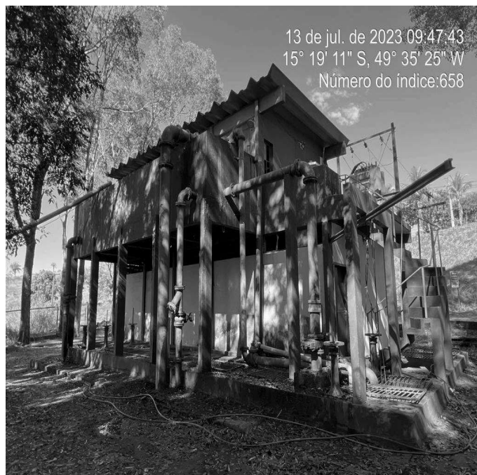
Foto 1 - EEAB/Captação Rio das Almas com pintura da edificação desgastada.
