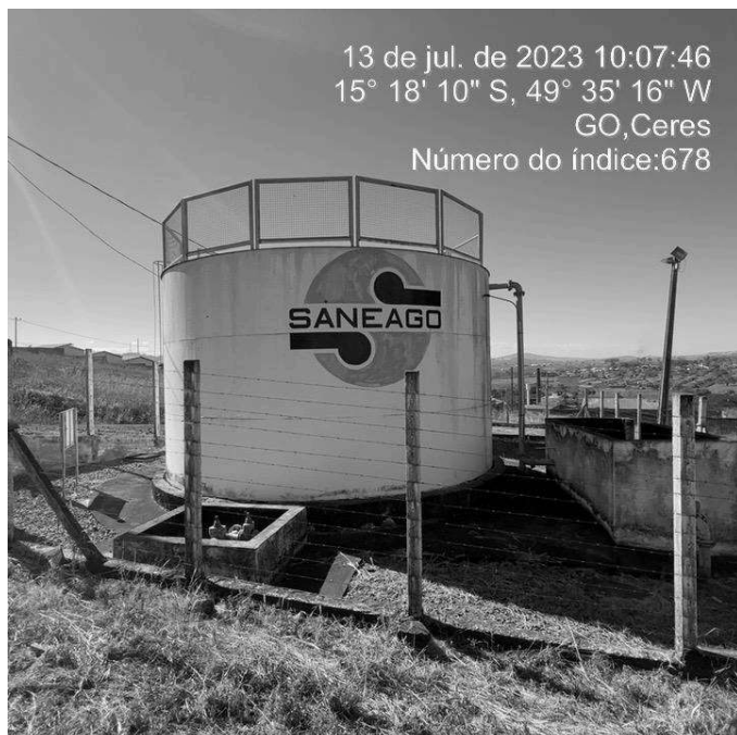
Foto 21 - RAP 100 m 3 Aldeia do Vale/metálico: Ausência de grade de proteção ou tampa nas caixas de passagem.
