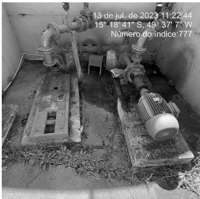
Foto 9 - Ausência de grade de proteção ou tampa nas caixas de passagem na EEAT/Sorriso II.
