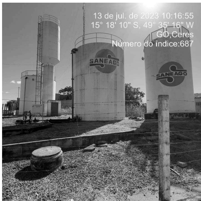
Foto 19 - REL 100 m 3 metálico Bouganville II com pintura desgastada.
