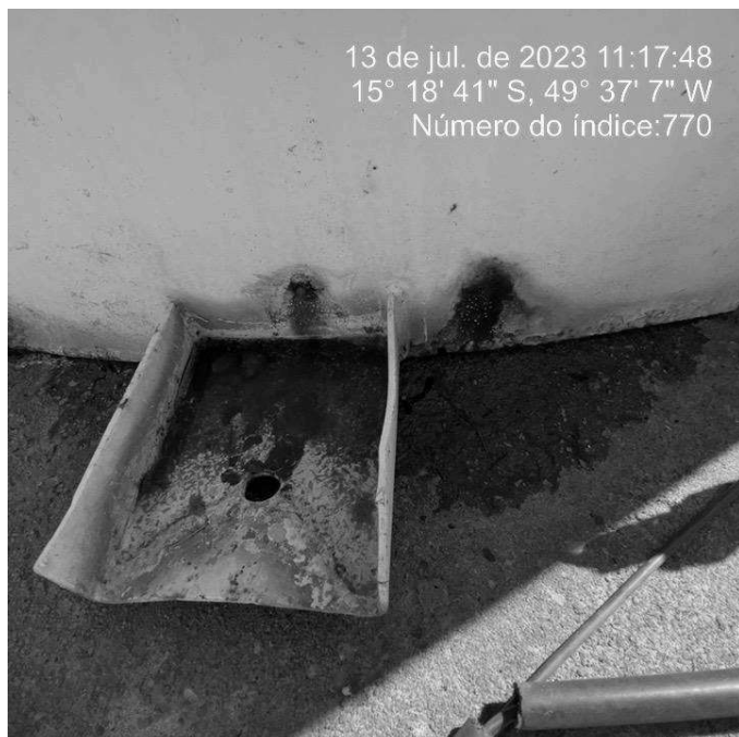
Foto 13 - RAP 150 m 3 metálico Sorriso I com vazamento na base do RAP.
