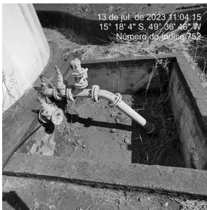
Foto 16 - RAP 100 m 3 metálico Tropical II com caixas de passagem sem tampas ou grade de proteção.
