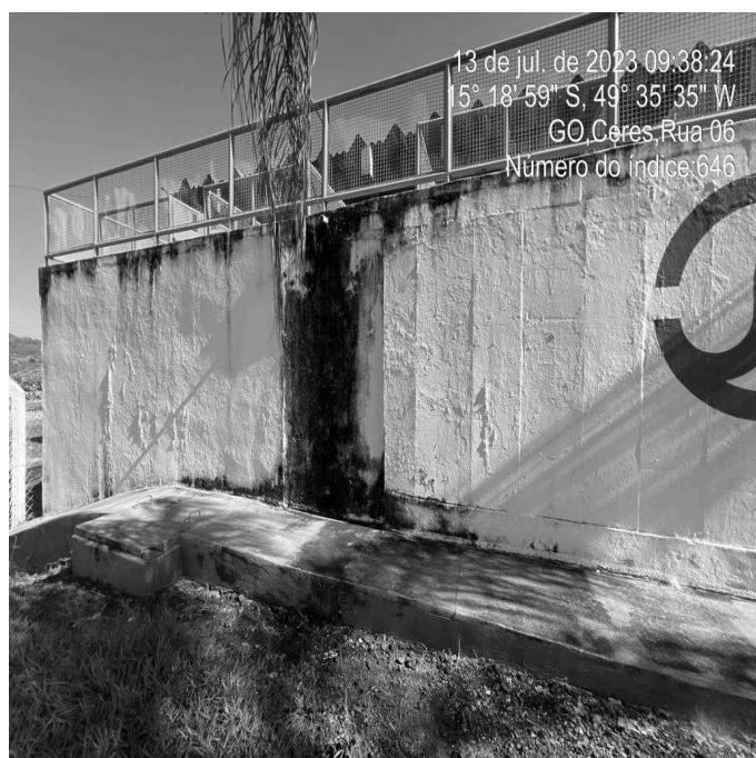
Foto 3 - ETA/infiltração na parte externa dos floculadores, decantadores e filtros.
