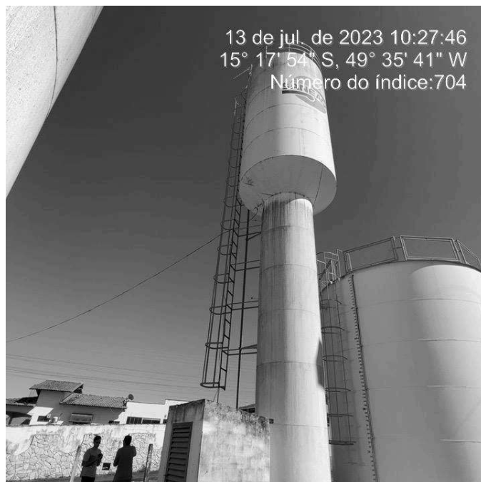
Foto 18 - REL 50 m 3 metálico, Bouganville II com pintura desgastada.
