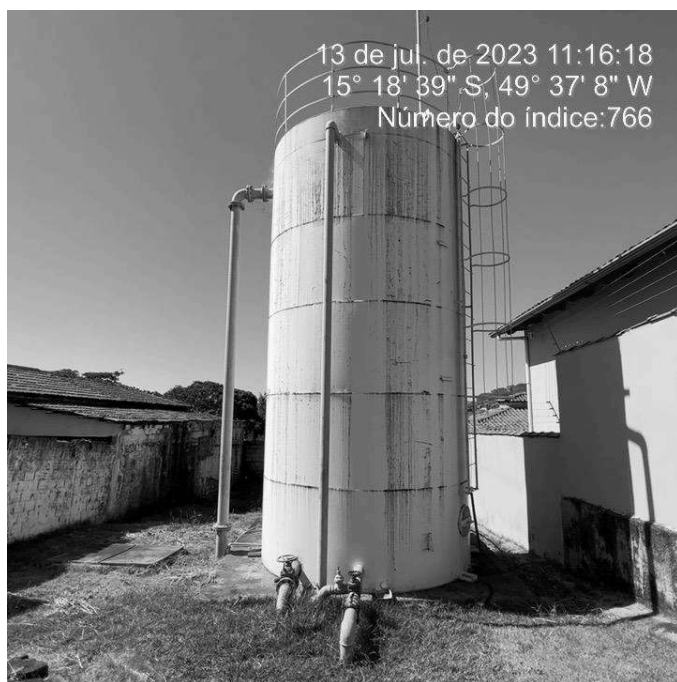
Foto 12 - RAP 150 m 3 metálico Sorriso I com pintura desgasta.
