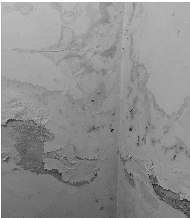
Foto 3 - ETA/Galeria de filtros: pintura desgastada, perda de revestimento e infiltração na parte interna da galeria dos filtros.
