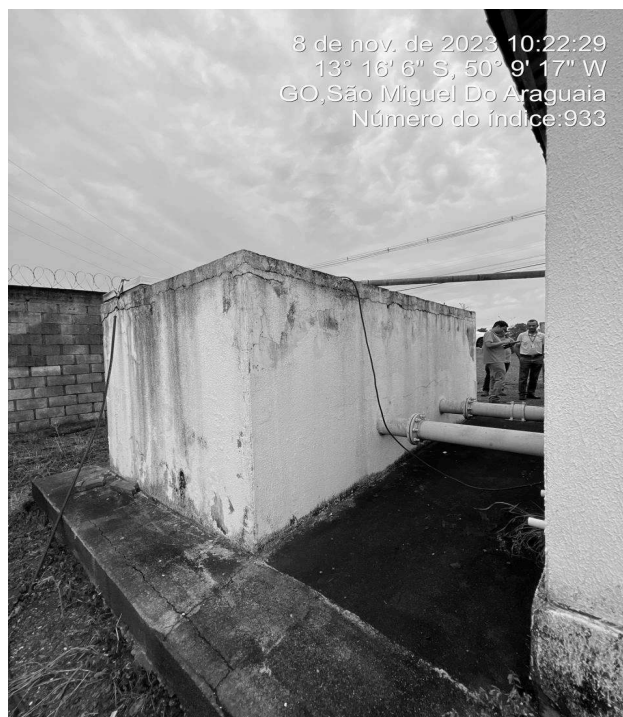
Foto 14 - RAP/REL Booster Vila Martins: pintura desgastada.
