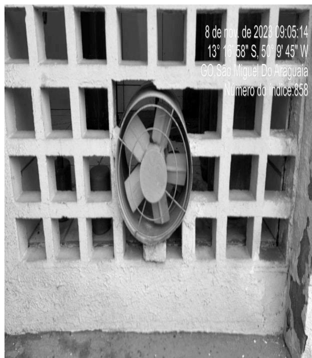
Foto 6 - ETA/Desinfecção, sala de cloração: exaustor danificado.
