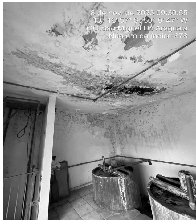
Foto 10 - ETA/Produtos químicos, casa de química: infiltração, perda de revestimento e pintura desgastada.
