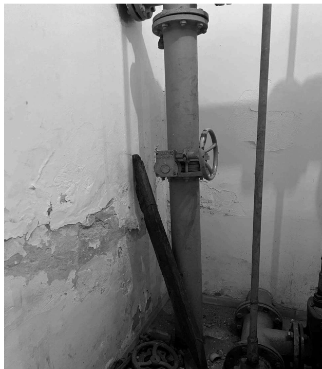
Foto 2 - ETA/Galeria de filtros: pintura desgastada, perda de revestimento e infiltração na parte interna da galeria dos filtros.
