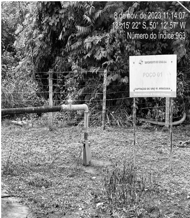
Foto 19 - Captação/EEAB Poço P1: condições de manutenção, conservação e segurança inadequada da área do poço, com fiação exposta.
