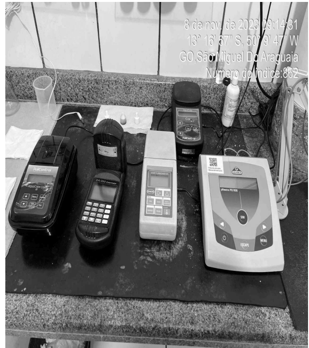
Foto 8 - ETA/Laboratório de processos: condições precárias de organização, instalado na copa/cozinha, sem armários e bancadas etc.
