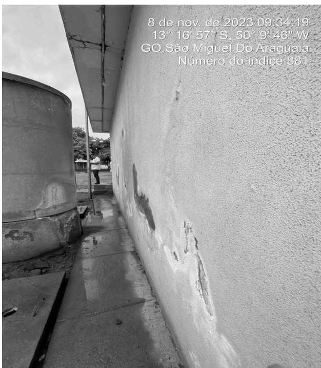
Foto 5 - ETA/Floculadores, decantadores e filtração: perda de revestimento e pintura desgastada.
