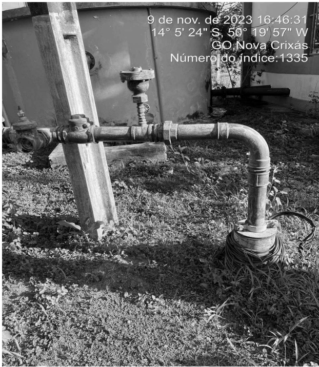
Foto 13 - Poço P 4, apresentando fiação exposta na área urbanizada do poço.
