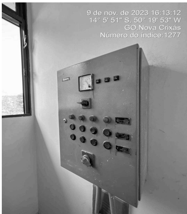
Foto 5 - ETA/Filtração, área de risco sem aviso de advertência no quadro de comando.
