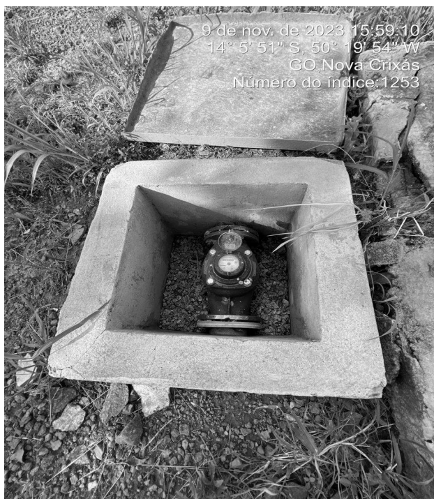
Foto 7 - REL/ETA 100 m 3 . RAP/Caixa de reunião dos poços (20 m 3 ), caixas de inspeção ou passagem, sem grade ou tampa de proteção adequada.
