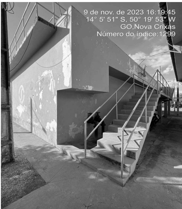
Foto 3 - ETA/infraestrutura, com infiltrações e pintura desgastada, em todas às edificações.
