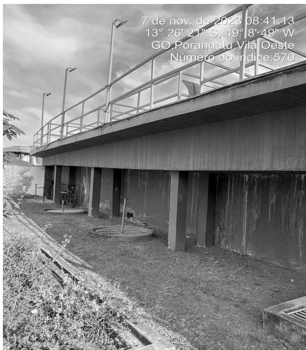
Foto 1 - ETA/Floculadores: trincas, eflorescências e mofo.
