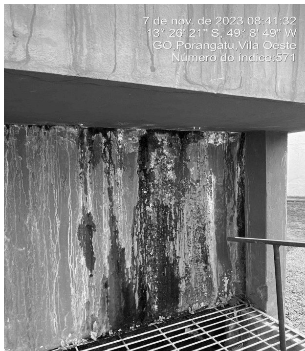
Foto 2 - ETA/Floculadores: apresentando trincas, eflorescência e mofo.
