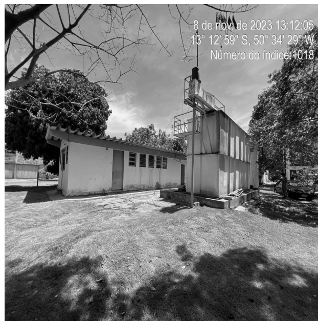
Foto 4 - Edificações da ETA com pintura desgastada.
