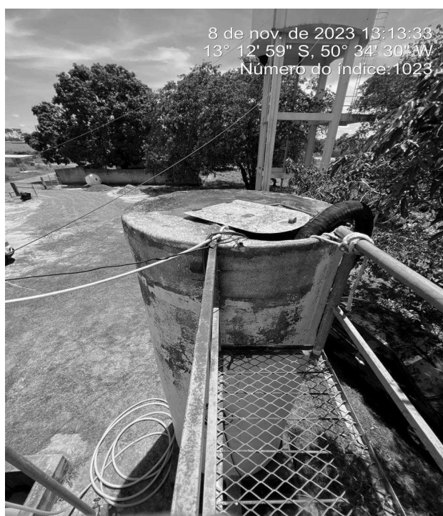
Foto 11 - RAP/Fibra de vidro 10 m 3 , tanque de contato da ETA, com pintura desgastada.
