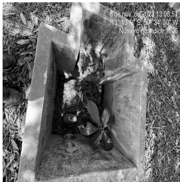
Foto 10 - ETA/caixa de registro sem grade ou tampa de proteção.
