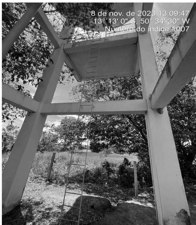
Foto 7 - REL/ETA, com ausência de guarda corpos na escada de acesso ao topo, parte inferior.
