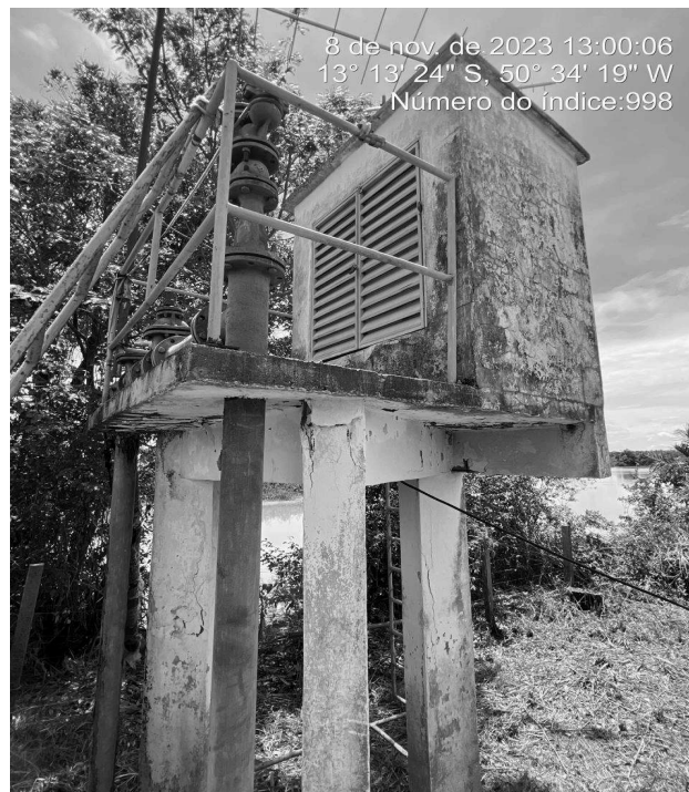
Foto 2 - Captação/EEAB com pintura desgastada e perda de revestimento e ferragem exposta.
