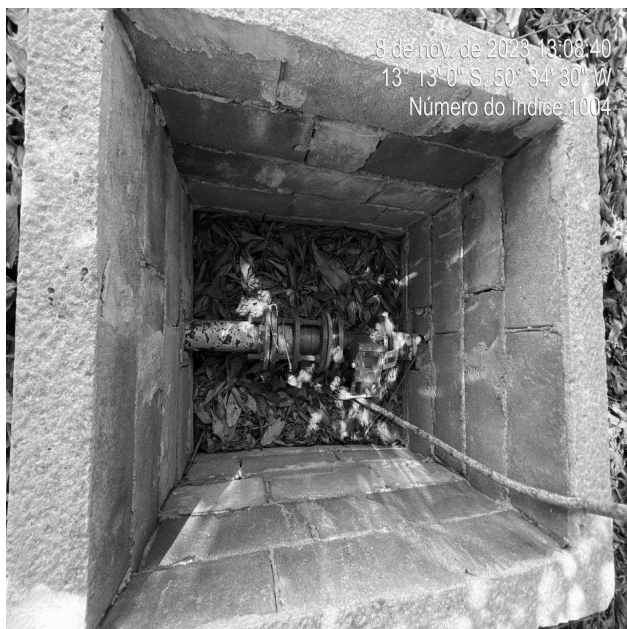
Foto 9 - ETA/Caixa do macro medidor sem grade ou tampa de proteção.
