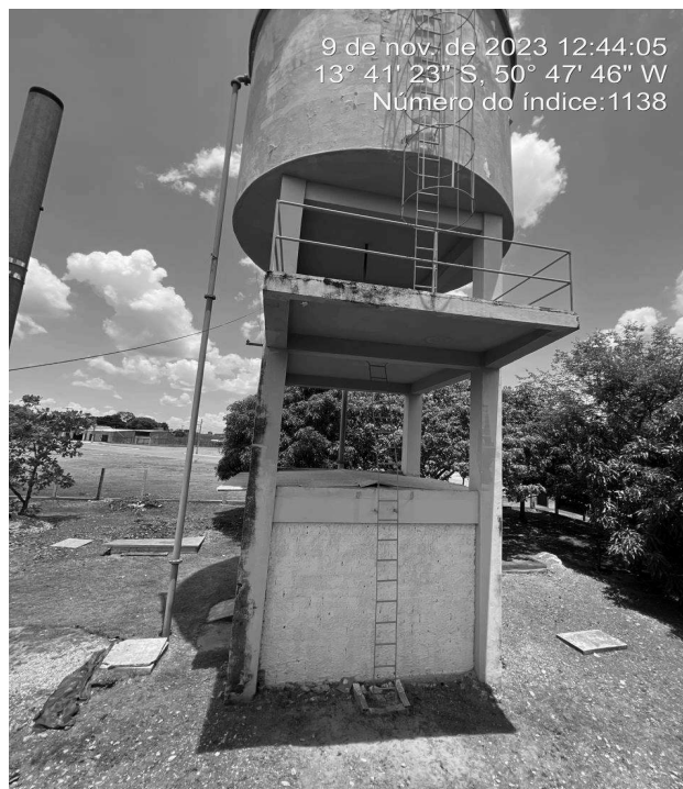
Foto 2 - REL/Escritório: ausência de guarda corpos na parte inferior da escada de acesso ao topo.
