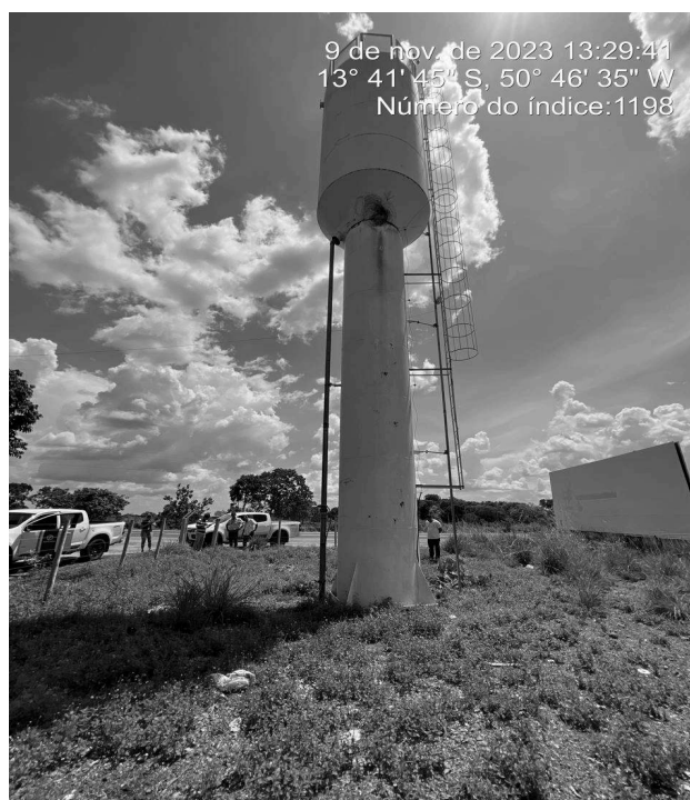
Foto 4 - REL/SEMARH: ausência de guarda corpos na parte inferior da escada de acesso ao topo.
