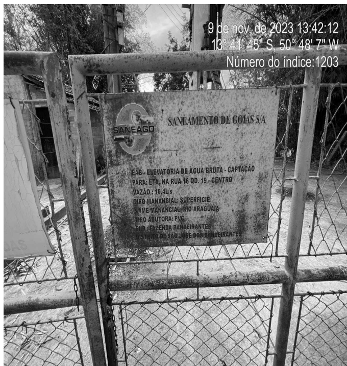
Foto 05 - EEAB/Captação Rio Araguaia: placa de identificação com pintura desgastada.
