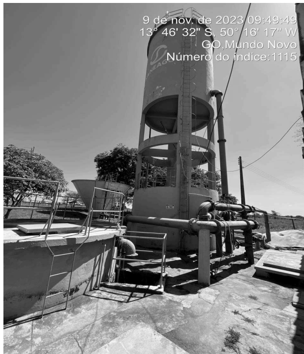
Foto 9 - REL/ETA: escada de acesso ao topo sem guarda corpos na parte inferior. Pintura desgastada do REL.
