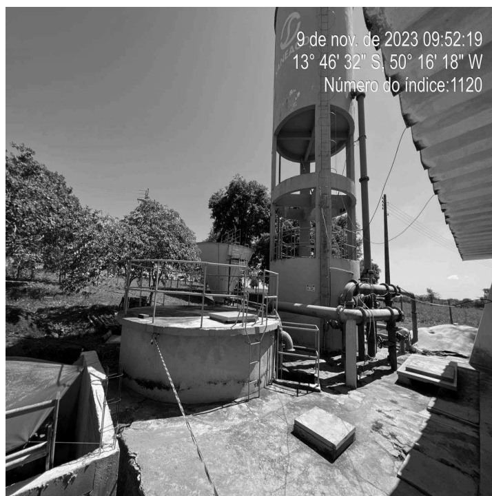
Foto 8 - RAP/ETA poço de contato: infiltração e pintura desgastada.
