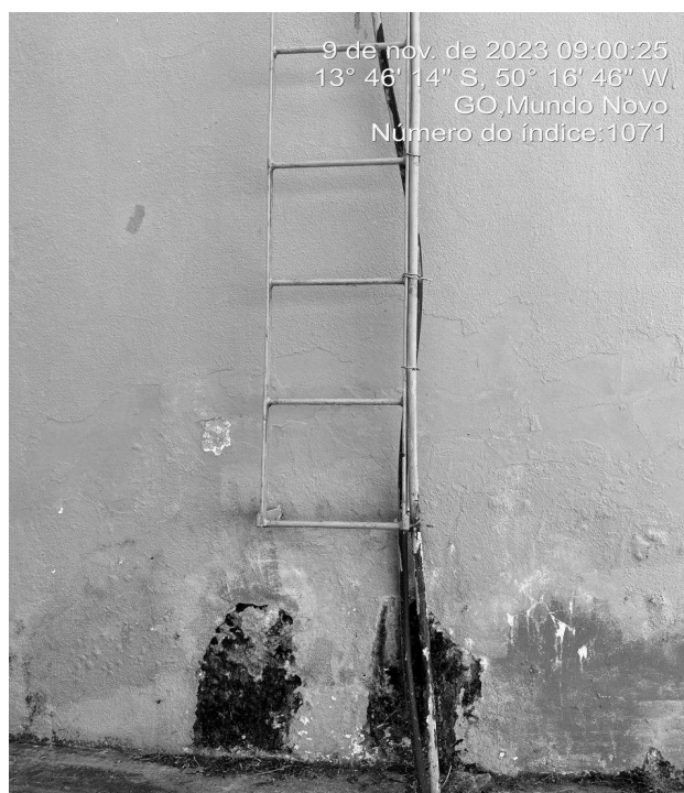
Foto 4 - RAP /Escritório: infiltração abaixo da escada.
