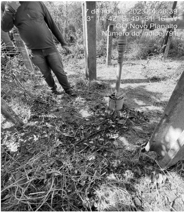
Foto 9 - Poço P9: fiação exposta na área urbanizada.
