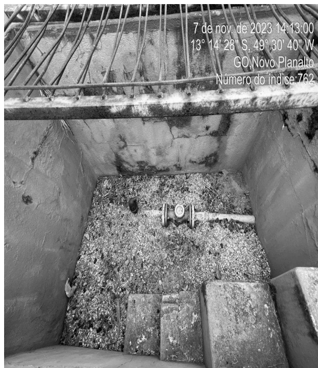
Foto 2 - REL/Escritório: caixa de inspeção ou passagem sem tampa ou grade de proteção adequada.
