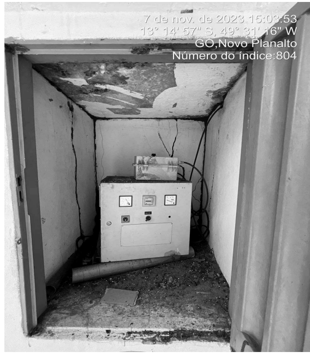
Foto 10 - Poço P17: quadro de comando sem sinalização de avisos de perigo nas áreas de risco.
