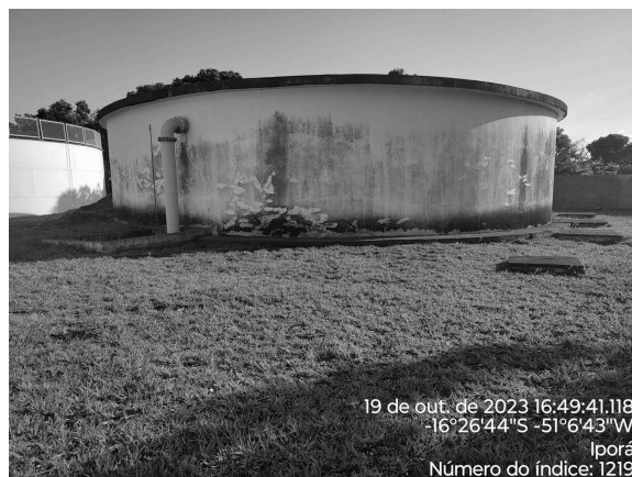
Foto 16 - RAP 1000 m 3 CR R1 com pintura desgastada.
