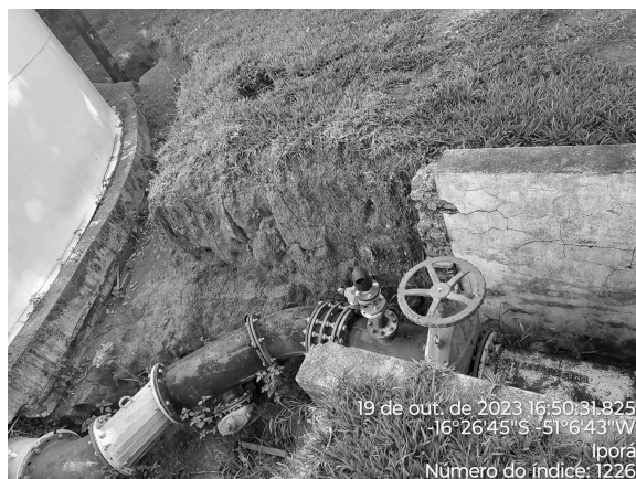
Foto 9 - Caixa de passagem CR R1 danificada.
