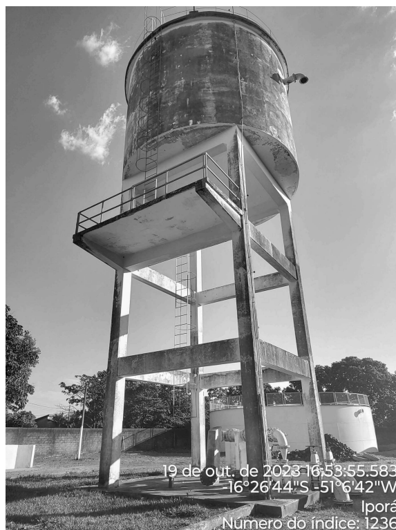
Foto 14 - REL 200 m 3 CR R1 com pintura desgastada.
