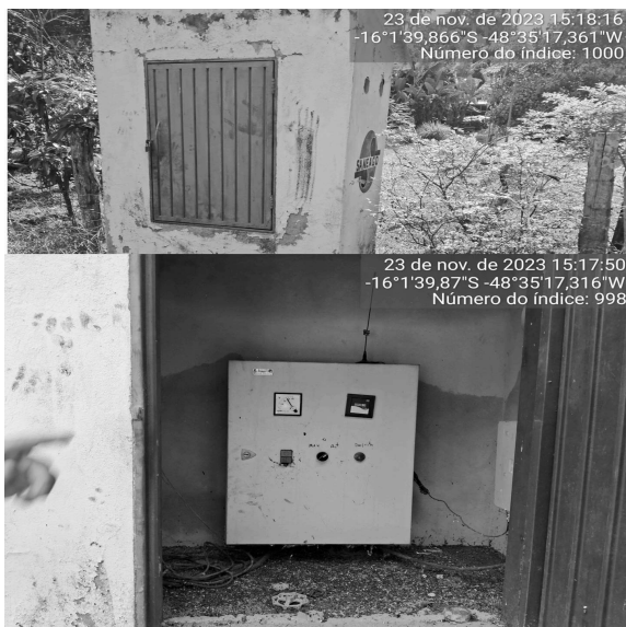
Foto 13 - Poço 01 com ausência de aviso de risco no quadro de comando.
