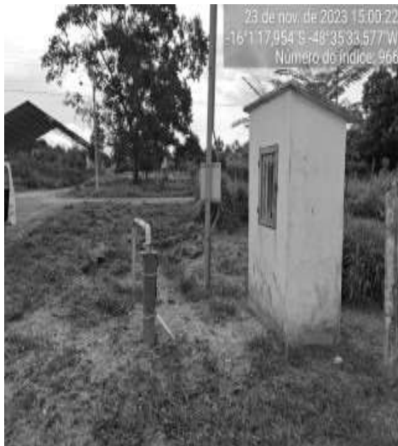
Foto 15 - Poço Câmara Filho (Olhos D'Água), com ausência de identificação e área do poço sem urbanização.
