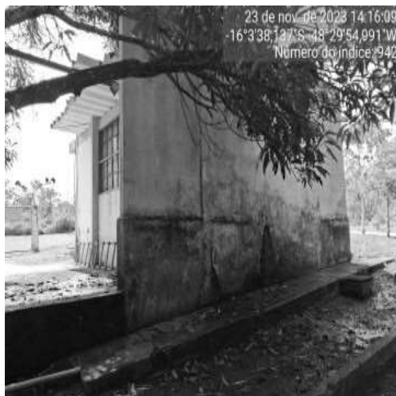
Foto 2 - Edificações da EEAB com perda de revestimento e pintura.
