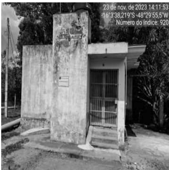
Foto 1 - Edificações da EEAB com perda de revestimento e pintura.
