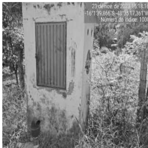
Foto 14 - Poço 01 com abrigo do quadro de comando com pintura desgastada.
