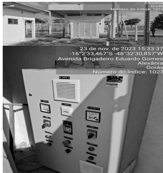
Foto 12 - Poço "Caminho dos Olhos d'água" com ausência de aviso de risco no quadro de comando.
