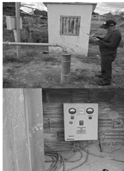
Foto 16/17 - Poço Câmara Filho (Olhos D'Água), com ausência de aviso de risco no quadro de comando.
