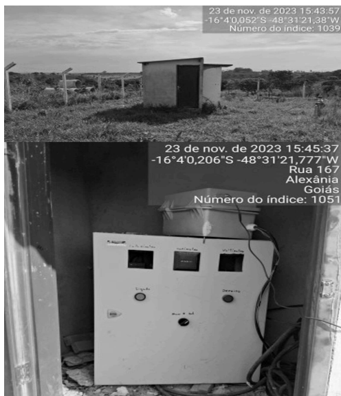
Foto 11 - Poço PFSH 37 com ausência de aviso de risco no quadro de comando.
