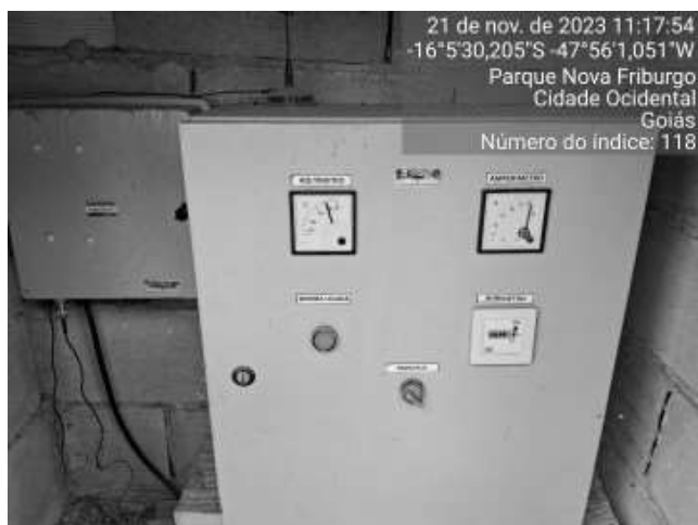
Foto 16 - Ausência de placas de aviso de perigo nas áreas de risco (Poço 5 - Friburgo B).
