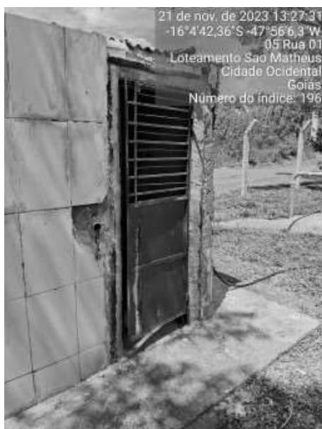
Foto 61 - Estrutura da casa de cloração danificada. Corrosão da porta metálica de acesso (Poço 1 - Sistema São Mateus).
