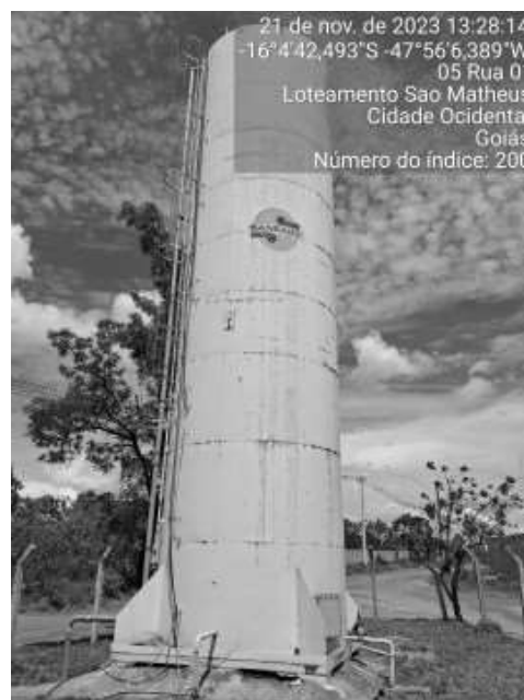
Foto 62 - Pintura desgastada do REL (Poço 1 - Sistema São Mateus).
