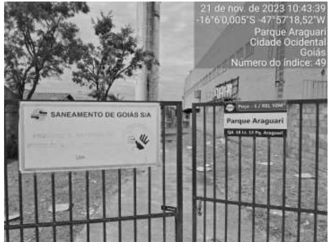
Foto 66 - REL com pintura danificada, ferrugem, vazamento de água e área com más condições de conservação (limpeza) CR Araguari.
