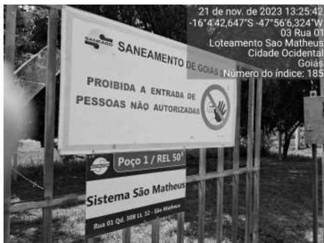
Foto 35 - Má condição de conservação da cerca/muro/portão da área (Poço 1 - Sistema São Mateus).
