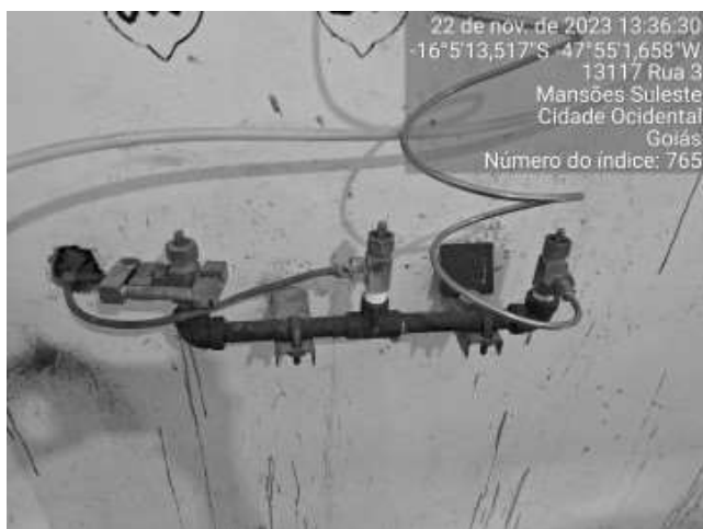
Foto 9 - Equipamentos de dosagem em mau estado de conservação (conexão do cloro gasoso) - ETA.
