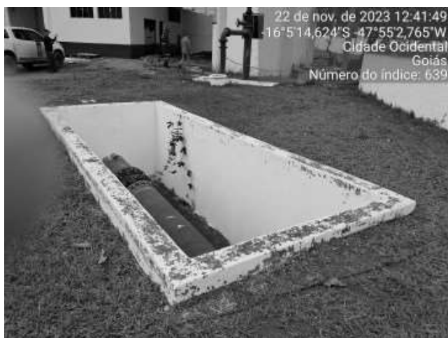
Foto 3 - Caixa de proteção, inspeção ou passagem existentes, sem tampa e ou grades de proteção adequadas (ETA).
