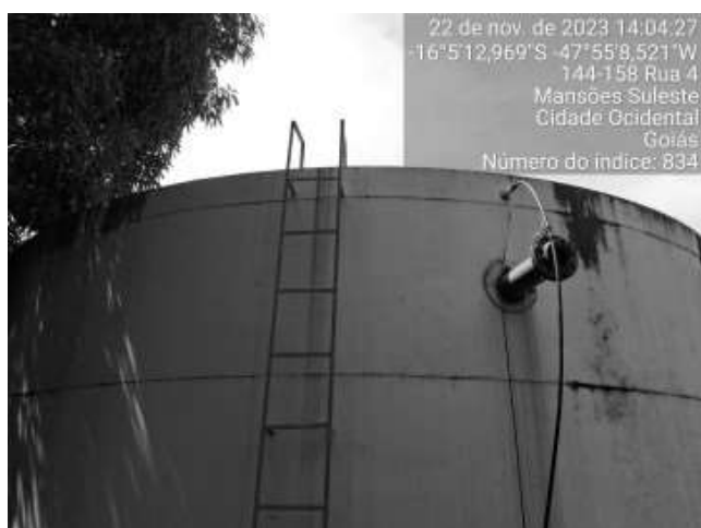
Foto 43 - Pintura desgastada, falta guarda corpo na escada de acesso e de grade de proteção no topo do RAP (RAP - Poço PGB 87).
