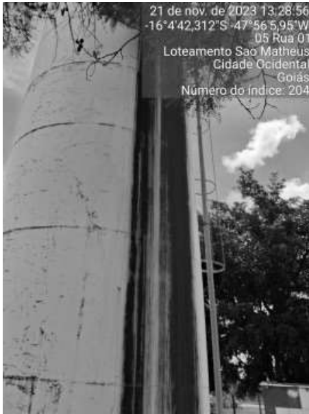
Foto 63 - REL com pintura danificada, ferrugem e vazamento de água (Poço 1 - Sistema São Mateus).
