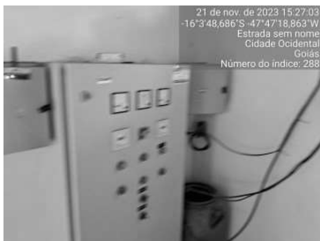
Foto 17 - Ausência de placas de aviso de perigo nas áreas de risco (CR Alphaville).
