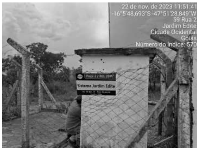
Foto 28 - Cerca de proteção da área danificada (Poço 2 - Sistema Jardim Edite).
