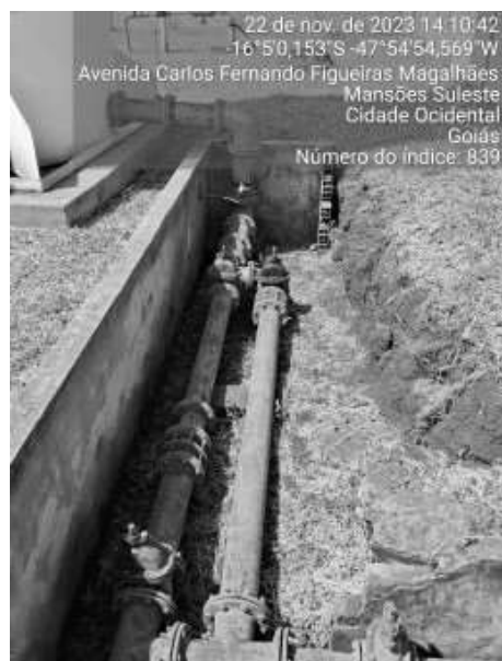
Foto 50 - Caixa de passagem ou inspeção sem tampa ou grades de proteção adequadas ( Sistema Dom Bosco - Poço PVI 01).
