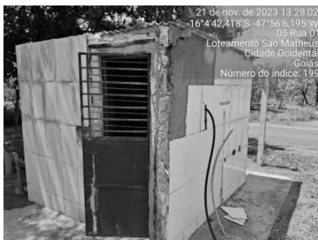
Foto 38 - Casa de química com perda de revestimento externo, pintura danificada e esquadrias metálicas com corrosão (Poço 1 - Sistema São Mateus).
