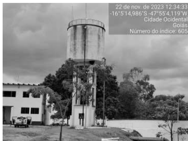
Foto 48 - REL com pintura desgastada (ETA).
