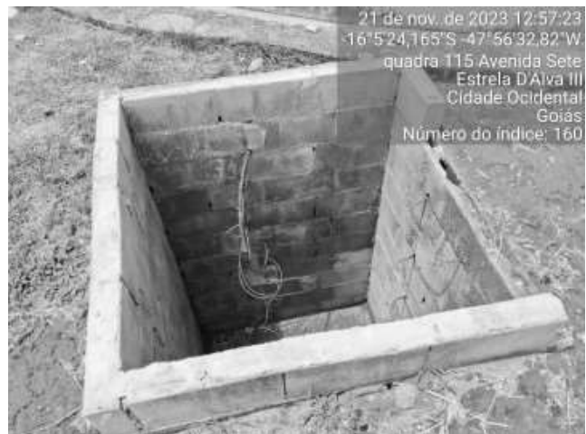
Foto 68 - Caixa de passagem ou inspeção sem tampa ou grades de proteção adequada (Sistema Mossoró - RAP 1000 m 3 ).
