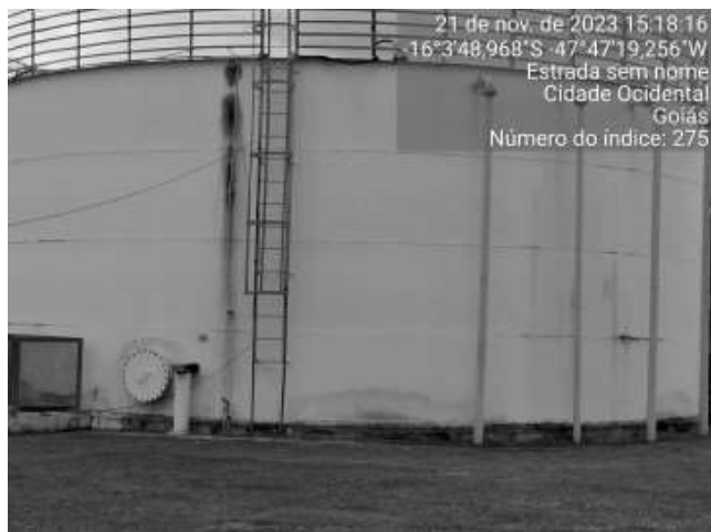
Foto 59 - RAP com estrutura metálica com pintura desgastada e ferrugem (RAP/500 m³ C.R. Alphaville).
