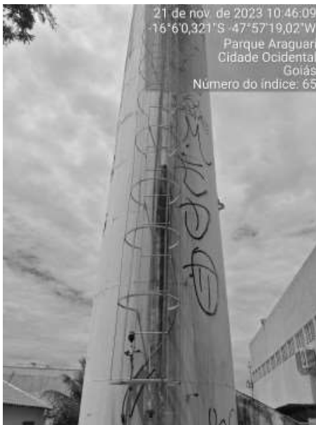
Foto 65 - REL com pintura danificada, ferrugem e vazamento de água - CR Araguari.
