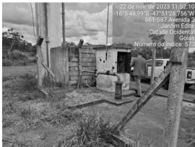
Foto 30 - Área em mal estado de conservação (Poço 2 - Sistema Jardim Edite).
