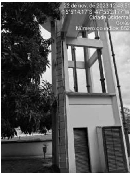
Foto 51 - Ausência de guarda corpo na escada de acesso ao topo, na parte inferior (ETA).
