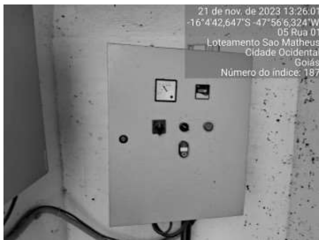
Foto 36 - Ausência de placas de aviso de perigo nas áreas de risco (Poço 1 - Sistema São Mateus).
