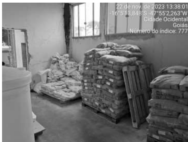
Foto 11 - Mal estado de conservação das edificações, com pintura desgastada e vazamentos, ventilação inadequada (ETA).
