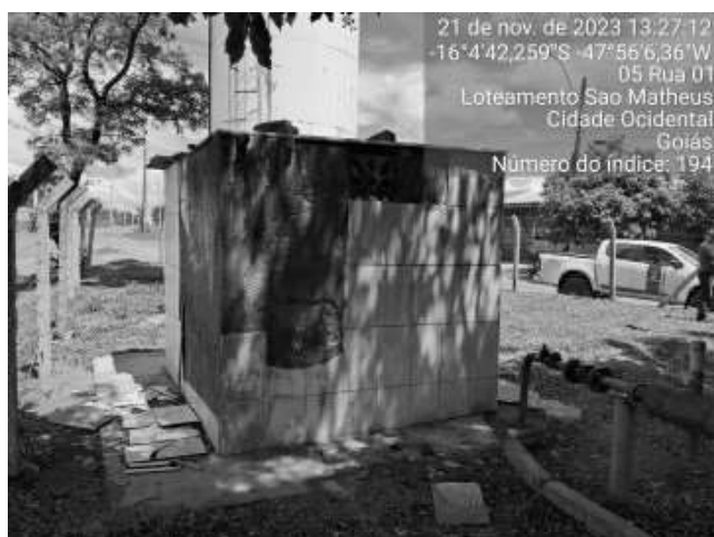
Foto 37 - Casa de química com perda de revestimento externo, pintura danificada e esquadrias metálicas com corrosão (Poço 1 - Sistema São Mateus).
