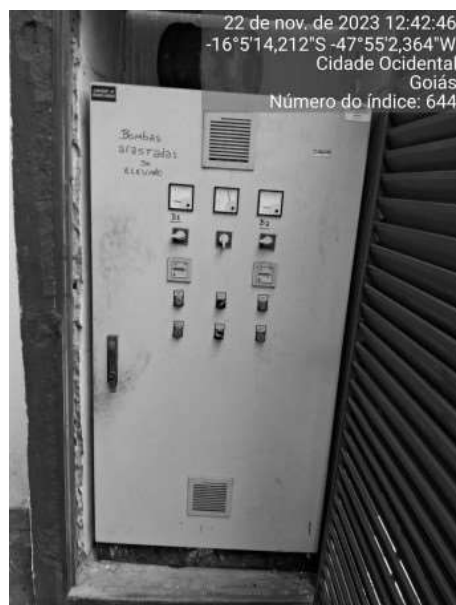
Foto 12 - Ausência de placas de aviso de perigo nas áreas de risco.
