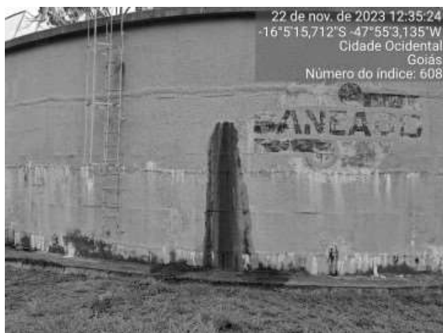
Foto 49 - Reservatório com pintura desgastada, infiltrações e mofo (ETA).
