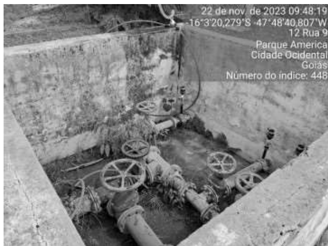
Foto 45 - Caixa de passagem ou inspeção sem tampa ou grades de proteção adequadas (Sistema Jardim ABC).
