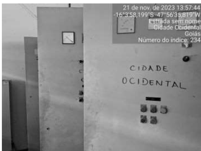
Foto 1 - Ausência de placas de aviso de perigo nas áreas de risco (Captação/EEAB).
