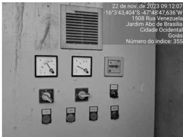
Foto 27 - Ausência placas de aviso de perigo nas áreas de risco (Poço 02 - Parque das Américas).
