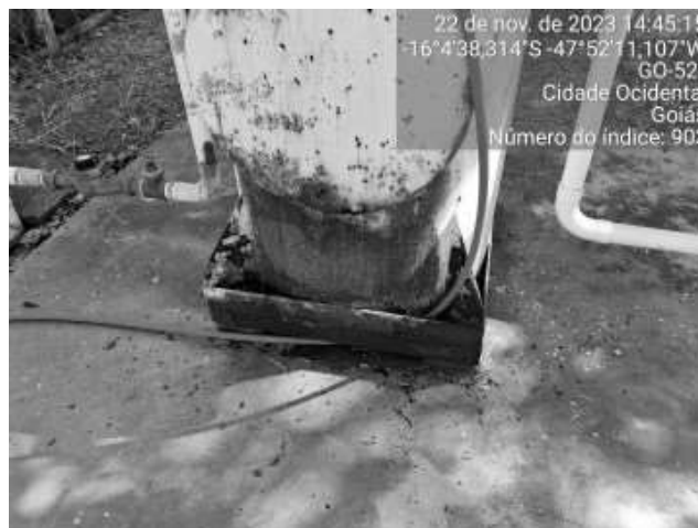
Foto 56 - Corrosão na base do REL (Poço 1 - REL 50 m 3 - Sistema Mesquita II).
