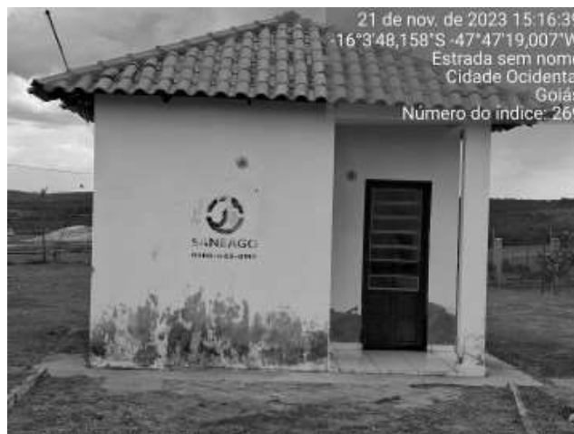
Foto 58 - Pintura danificada, casa de cloração com perda de revestimento externo (RAP/500 m 3 C.R. Alphaville).
