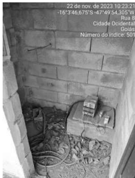
Foto 32 - Quadro de comando soft instalado fora de padrão (Poço Jardim das Oliveiras).
