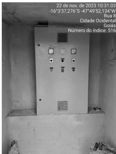
Foto 13 - Ausência de placas de aviso de perigo nas áreas de risco (Poço 1 Sistema São Mateus).
