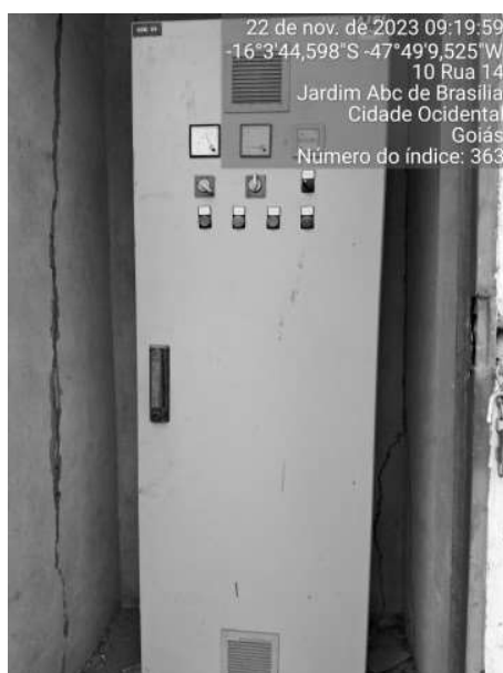
Foto 25 - Ausência placas de aviso de perigo nas áreas de risco (Poço 5 - Jardim ABC).
