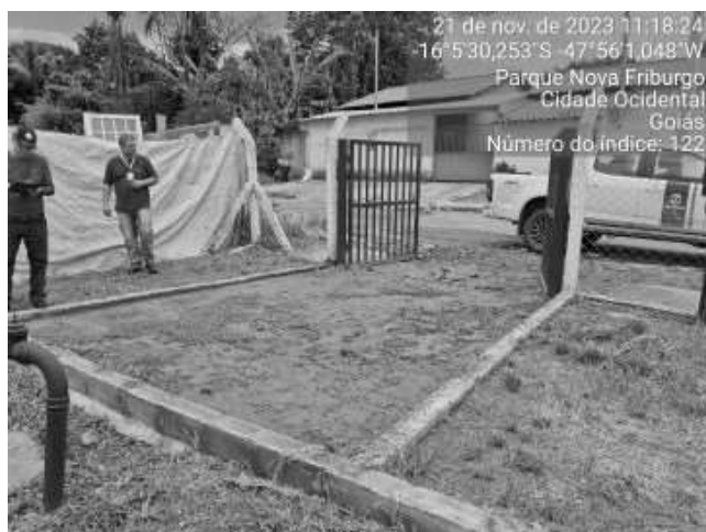
Foto 40 - Ausência de placa de identificação da unidade de SAA (Poço 5 Friburgo B).
