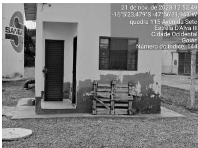
Foto 18 - Casa de química com perda de revestimento, pintura desgastada e esquadrias metálicas com corrosão acentuada (EEAT Mossoró).
