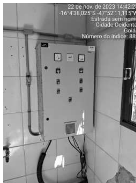
Foto 54 - Casa de cloração com perda de revestimento interno (Poço 1 - REL 50 m 3 - Sistema Mesquita II).
