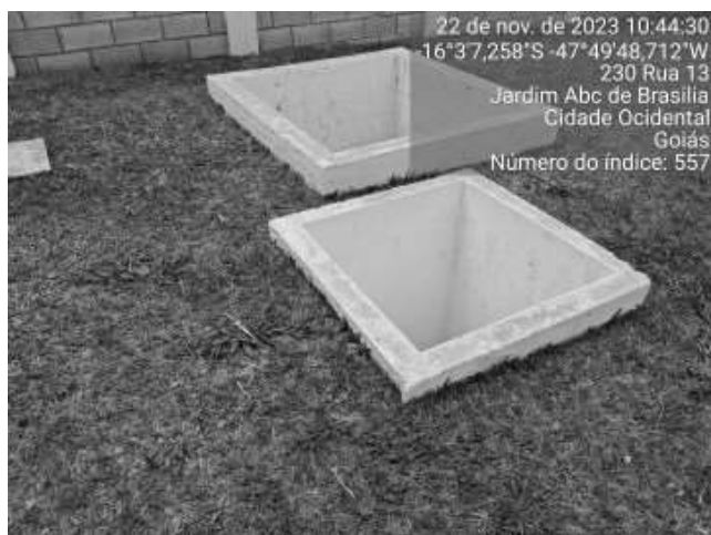
Foto 47 - Caixas de passagem ou inspeção sem tampas ou grades de proteção adequadas (Reservatório Jardim Ouro Verde).
