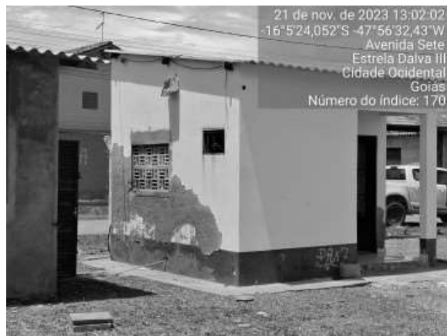
Foto 72 - Casa de cloração em má condição de conservação. Infiltração, perda de revestimento e pintura desgastada (Sistema Mossoró).
