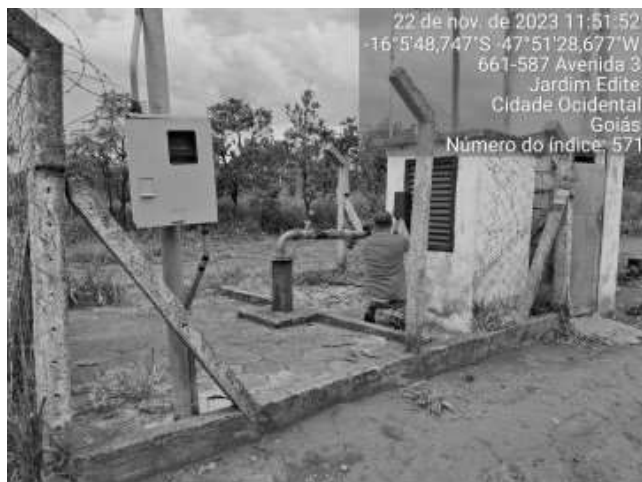
Foto 29 - Cerca de proteção da área danificada (Poço 2 - Sistema Jardim Edite).
