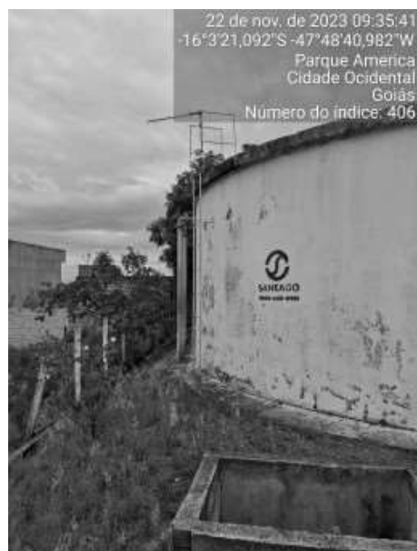
Foto 44 - Pintura desgastada, falta guarda corpos na escada e topo do RAP e caixa de passagem ou inspeção sem tampa ou grades de proteção adequadas (RAP Sistema Dom Bosco).
