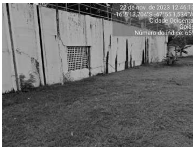
Foto 2 - Edificações da ETA com desgaste de pintura.
