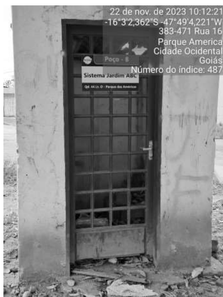
Foto 19 - Abrigo do quadro de comando com pintura danificada (Poço B Sistema ABC).
