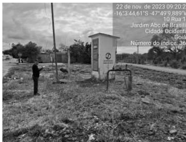
Foto 26 - Ausência de cerca de proteção da área (Poço 5 - Jardim ABC).
