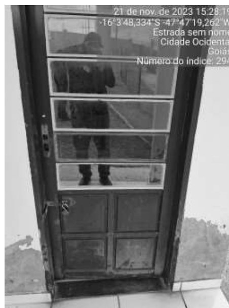
Foto 60 - Estrutura metálica da porta de acesso com corrosão/ferrugem (RAP/500 m³ C.R. Alphaville).
