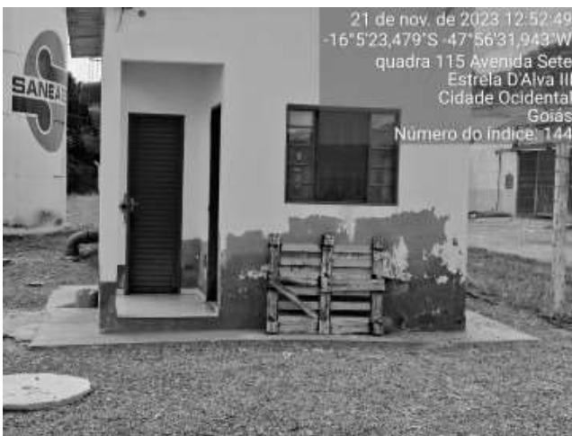
Foto 71 - Casa de cloração em má condição de conservação. Infiltração, perda de revestimento e pintura desgastada (Sistema Mossoró).
