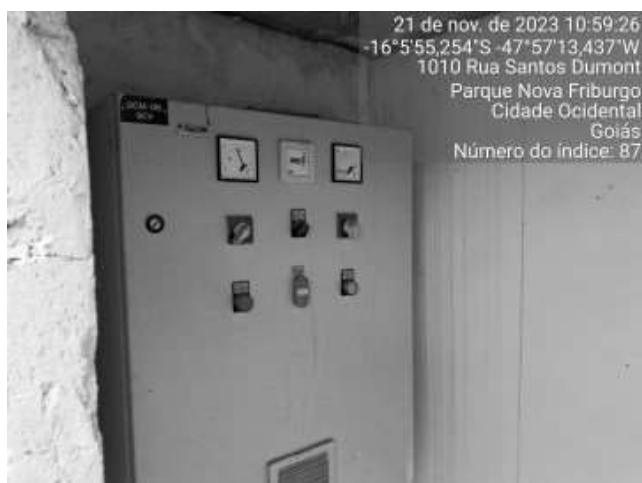
Foto 42 - Ausência de placas de aviso de perigo nas áreas de risco (Poço PSNI -01).
