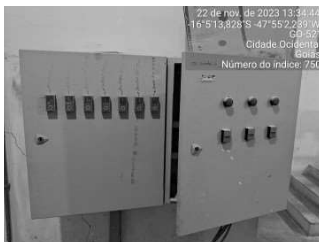
Foto 8 - Ausência de placas de aviso de perigo nas áreas de risco (ETA).
