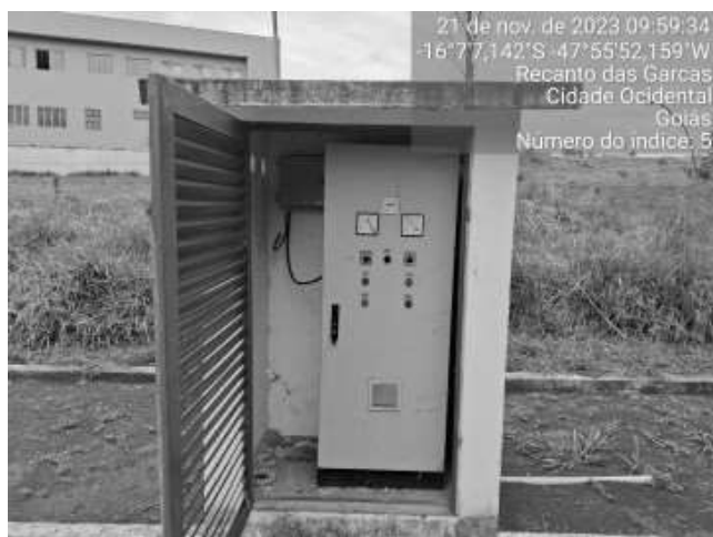
Foto 15 - Ausência de placas de aviso de perigo nas áreas de risco (Sistema Morada das Garças - Poço 1).
