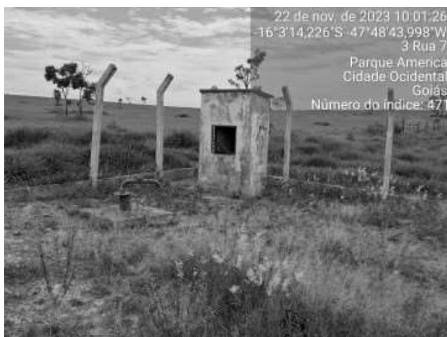
Foto 20 - Abrigo do quadro de comando com pintura danificada (Poço 10 - Parque das Américas).
