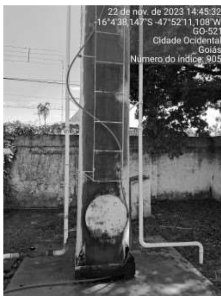
Foto 57 - Pintura danificada, corrosão na base do REL (Poço 1 - REL 50 m 3 - Sistema Mesquita II).
