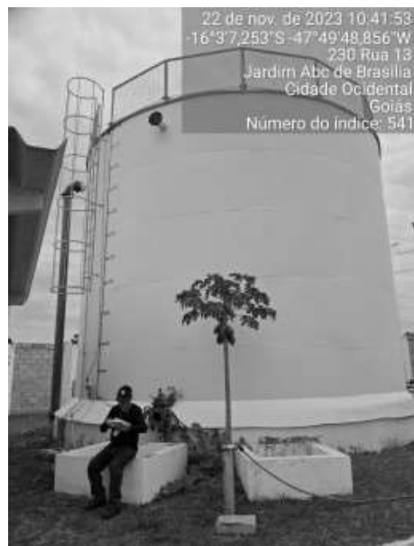
Foto 46 - Caixas de passagem ou inspeção sem tampas ou grades de proteção adequadas (Reservatório Jardim Ouro Verde).
