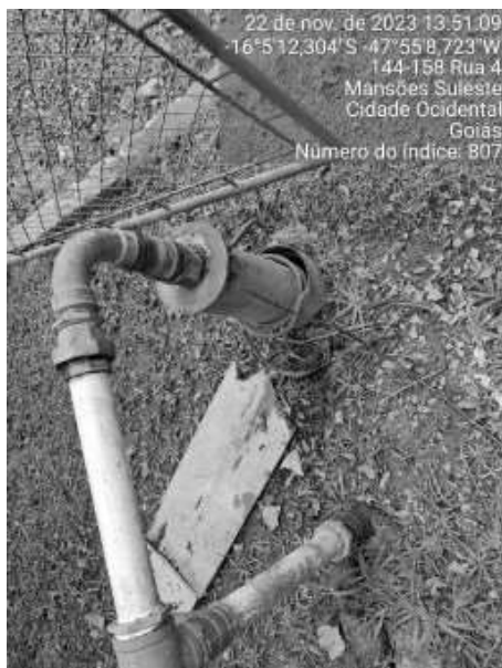
Foto 31 - Ausência de laje de proteção sanitária do poço (RAP- Poço PGB 87).
