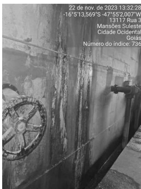
Foto 7 - Instalações da ETA com infiltração, eflorescência e trincas - vista interna.
