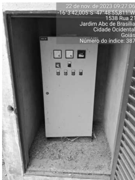
Foto 23 - Ausência placas de aviso de perigo nas áreas de risco (Poço 4 - Sistema Jardim ABC).
