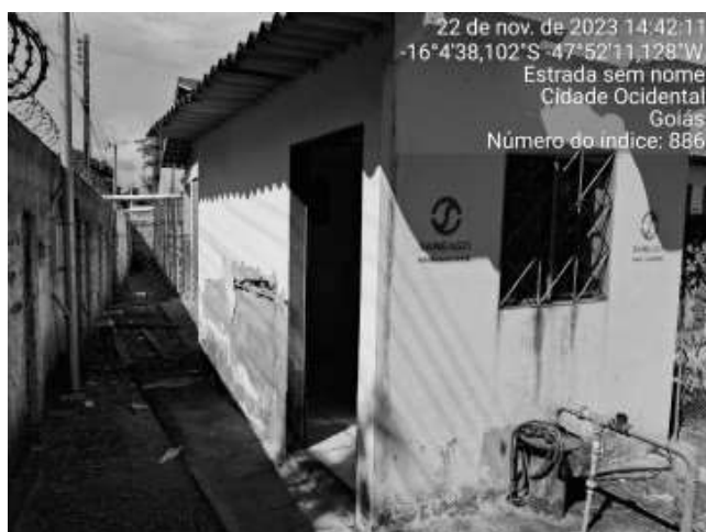
Foto 53 - Casa de cloração com perda de revestimento interno e externo, estrutura metálica com corrosão (Poço 1 - REL 50 m 3 - Sistema Mesquita II).
