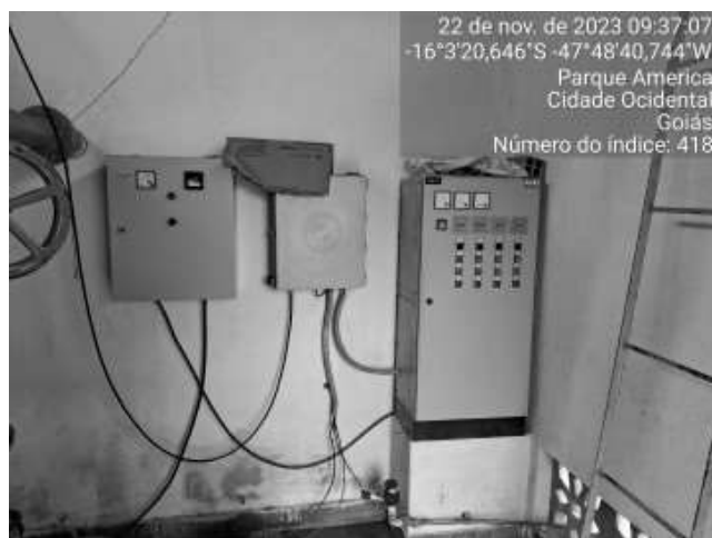
Foto 14 - Ausência de placas de aviso de perigo nas áreas de risco (Sistema Jardim ABC REL 100 m 3 - RAP/300 m 3 ).
