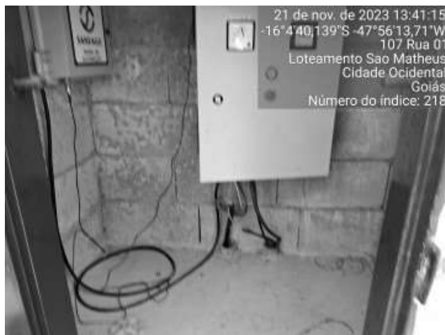
Foto 34 - Ausência de placas de aviso de perigo nas áreas de risco (Poço PSM 02).
