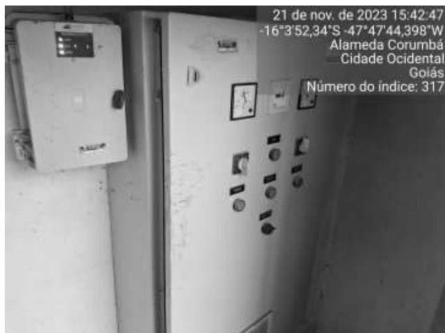
Foto 33 - Ausência de placas de aviso de perigo nas áreas de risco (Poço 06 Alameda Mamoré).
