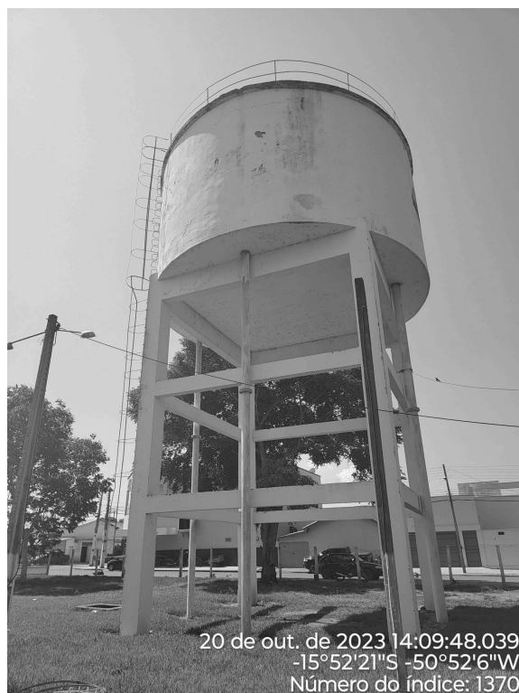
Foto 18 - Reservatórios ETA com pintura desgastada.
