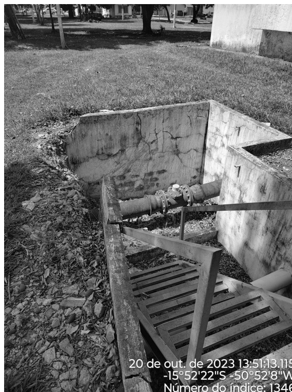
Foto 8 - Área da ETA com caixas de passagem sem tampa ou grade de proteção adequada/danificada.
