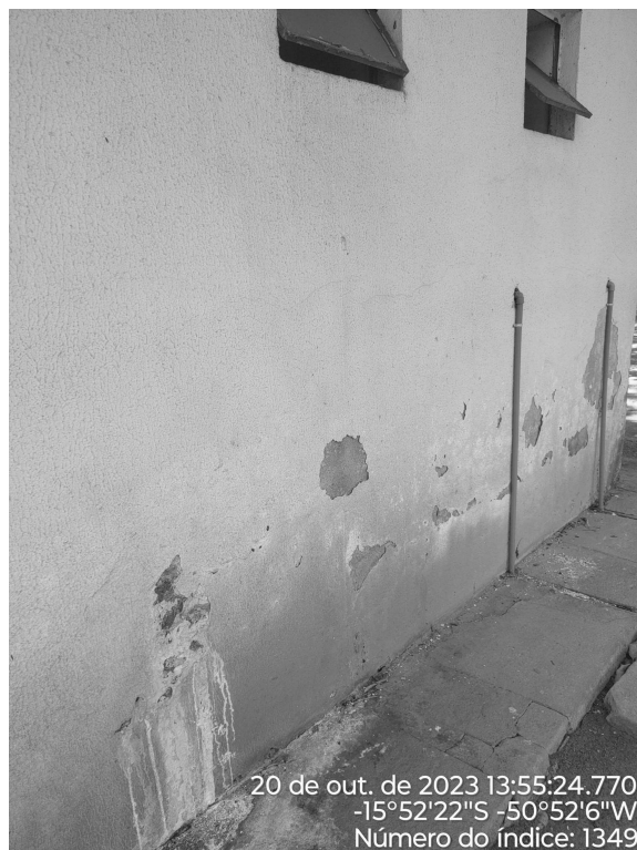
Foto 16 - Edificações da ETA com pintura desgastada e perda de revestimento.
