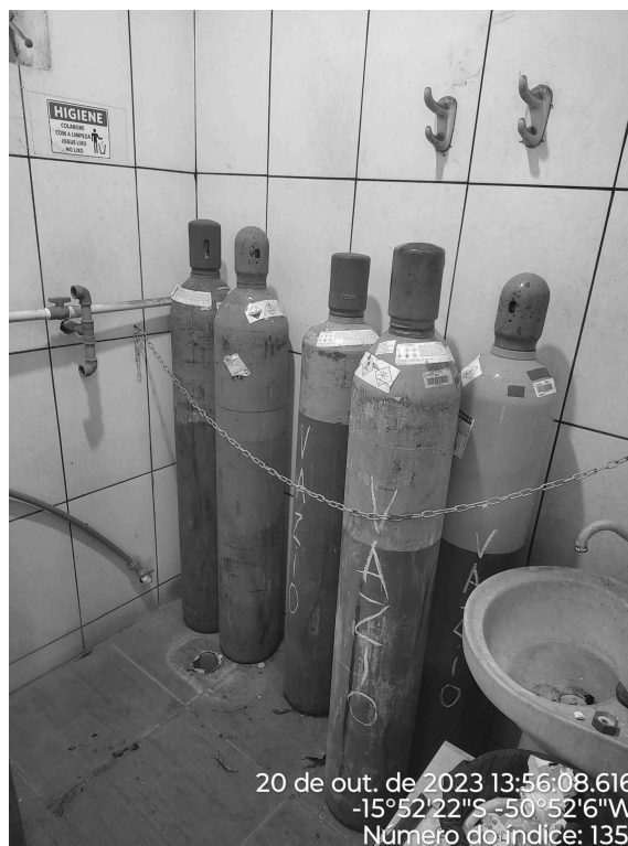
Foto 10 - Sala do clorador sem exaustor.
