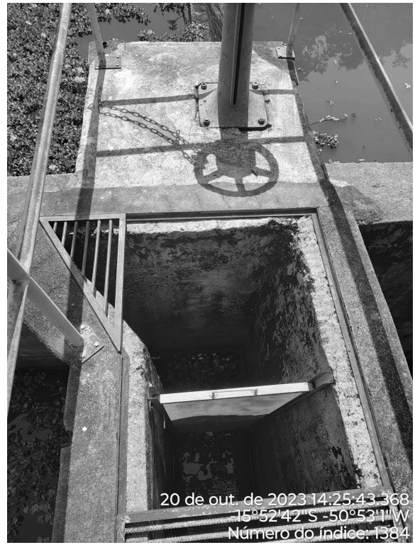
Foto 12 - Ausência de uma das grades da plataforma da barragem de captação.
