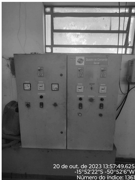
Foto 3 - Área de risco da EEAT (Casa de bombas) ETA sem aviso de advertência.
