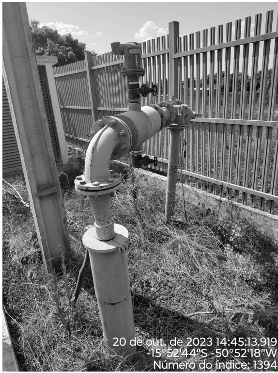
Foto 11 - P6 com ausência de laje de proteção no poço.
