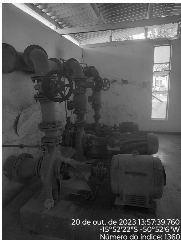
Foto 17 - Abrigo da EEAT (casa de bombas) com pintura desgastada.
