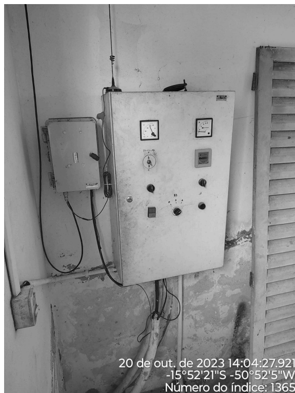
Foto 4 - Área de risco do Booster Alto Paraíso (ETA) sem aviso de advertência
