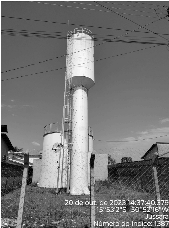
Foto 19 - REL Alto Paraíso com pintura desgastada.
