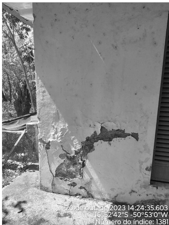
Foto 15 - Presença de perda de revestimento na edificação da captação.
