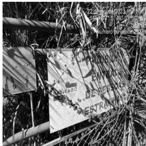
Foto 8 - Placa de identificação danificada no Poço 3.
