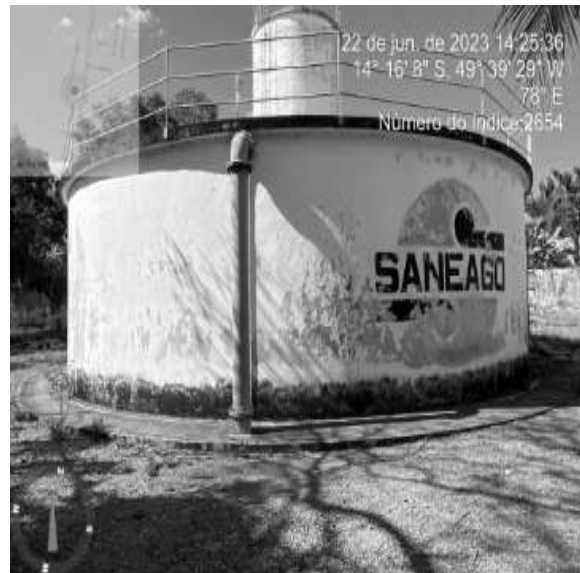
Foto 4 - RAP do C.R. do distrito com presença de pintura desgastada.
