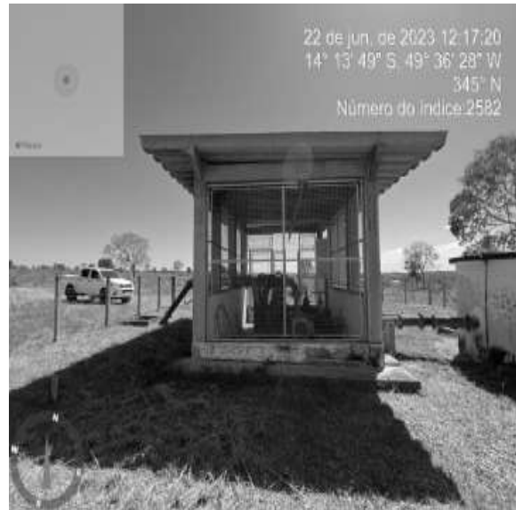
Foto 2 - Presença de pintura desgastada na caixa de reunião e nas edificações da EEAB 3.
