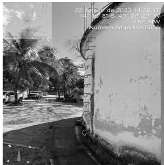
Foto 6 - Ausência de guarda corpos na escada do RAP do C.R. do distrito.
