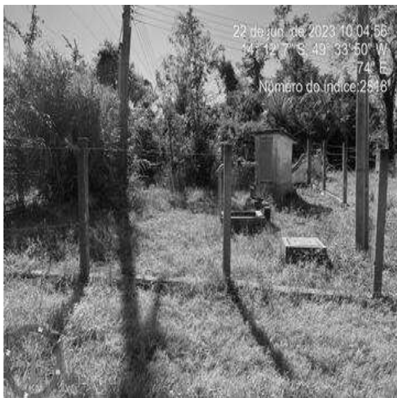
Foto 7 - Poço 3 com cerca danificada e pintura desgastada no abrigo do quadro.
