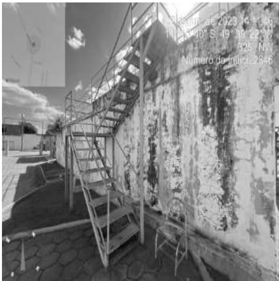
Foto 3 - Edificações da ETA com pintura desgastada.
