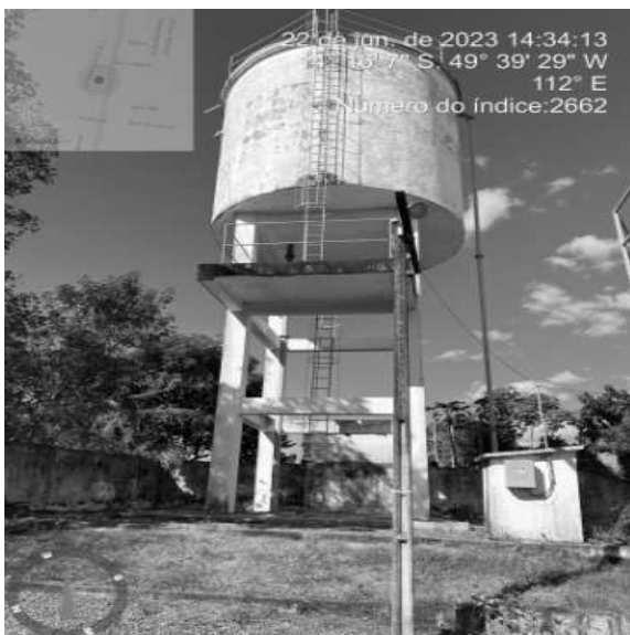
Foto 5 - REL do C.R. do distrito com presença de pintura desgastada.
