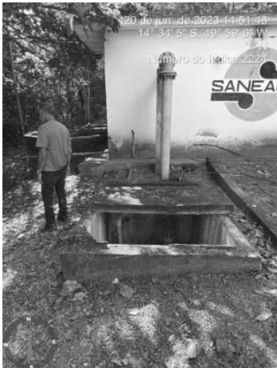
Foto 1 - Caixa de passagem com tampa danificada na EEAB.
