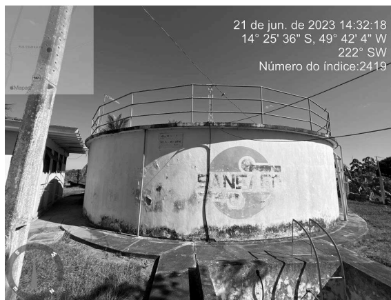
Foto 8 - RAP do CR Booster com presença de perda de revestimento e pintura desgastada
