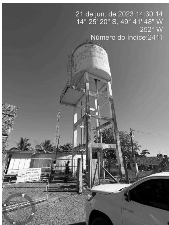
Foto 9 - REL do CR Booster com pintura desgastada.
