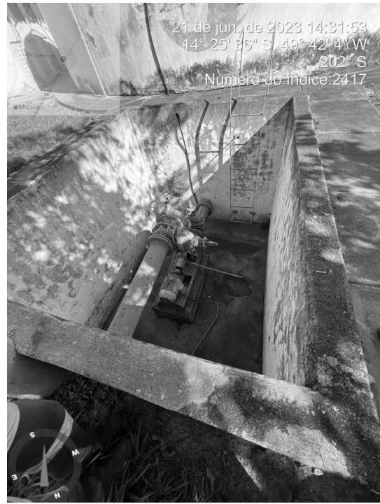
Foto 4 - Caixa de passagem sem tampa ou grade de proteção adequada no Reservatório Elevado Setor Sul.
