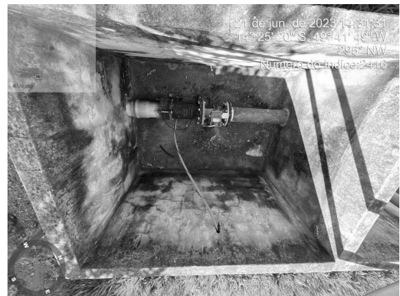
Foto 2 - Caixa de passagem sem tampa ou grade de proteção adequada no Reservatório Elevado Setor Sul.
