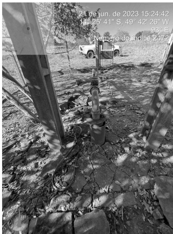
Foto 22 - Laje de proteção danificada no Poço 6.
