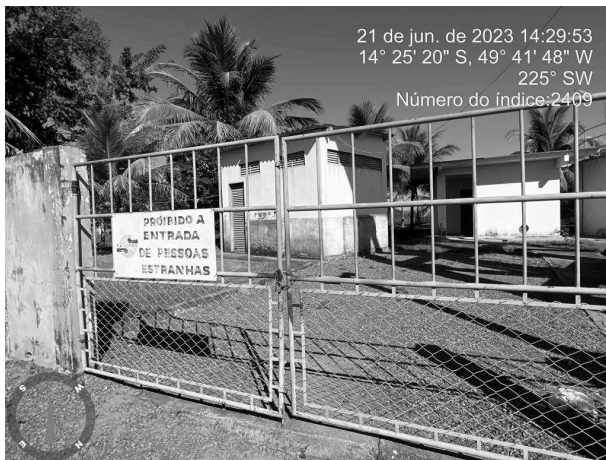
Foto 1 - Booster com placa de identificação desgastada.
