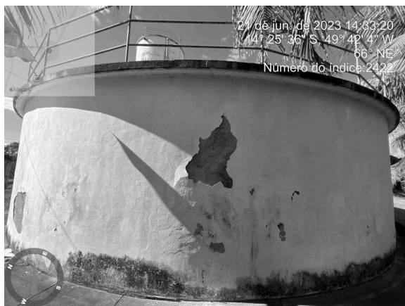
Foto 7 - RAP do CR Booster com presença de perda de revestimento e pintura desgastada
