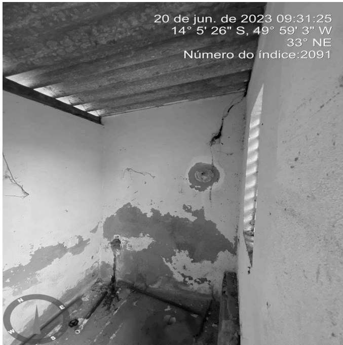
Foto 5 - Poço 02/Vila Sertaneja - abrigo do quadro de comando com pintura desgastada e perda de revestimento.
