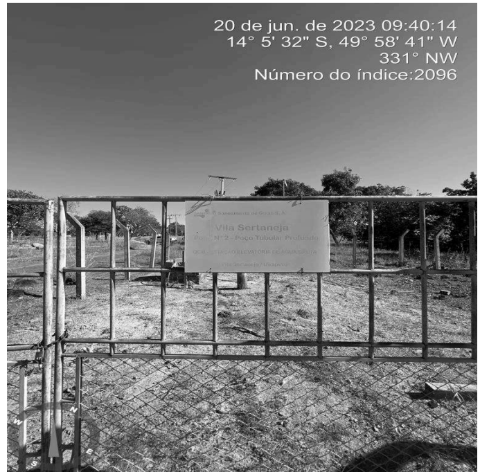
Foto 6 - Poço 02/Vila Sertaneja - placa de identificação do poço com pintura desgastada.
