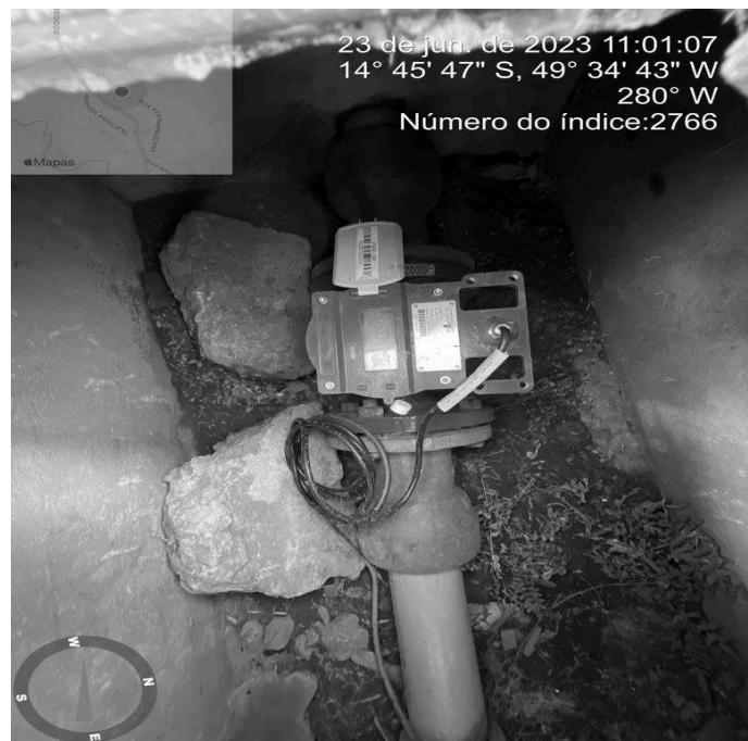
Foto 2 - ETA caixas de passagem sem grades ou tampas de proteção.
