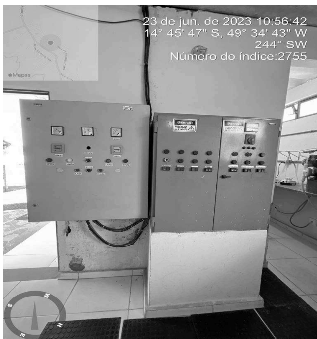
Foto 8 - Quadro de comando (lado esquerdo) sem avisos de perigo nas áreas de risco.
