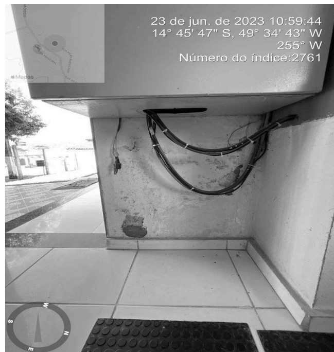
Foto 4 - ETA/Desgaste de pintura das edificações.
