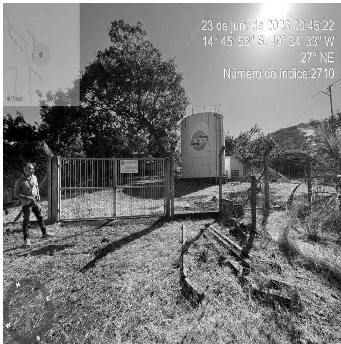
Foto 11 - RAP/Papuã com pintura desgastada.
