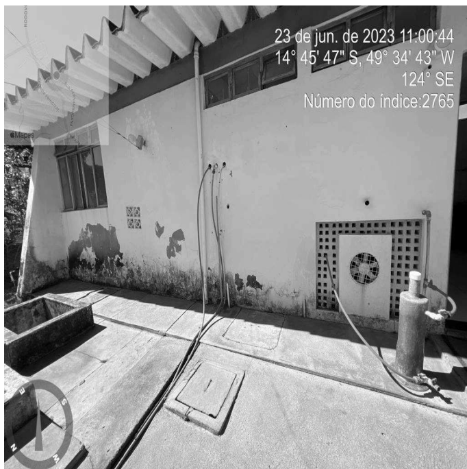
Foto 3 - ETA/Desgaste de pintura das edificações.
