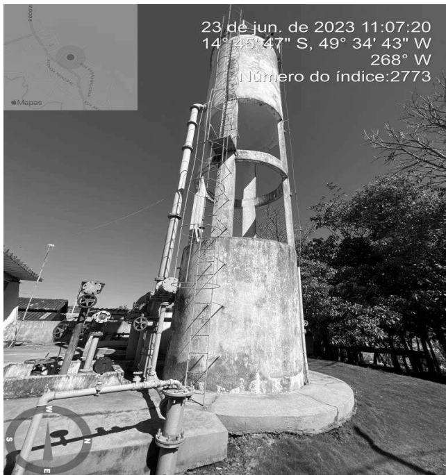
Foto 9- REL/ETA com desgaste de pintura.
