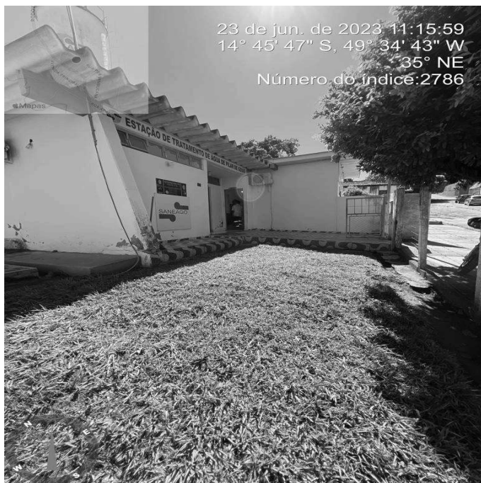
Foto 5 - ETA/Desgaste de pintura das edificações.
