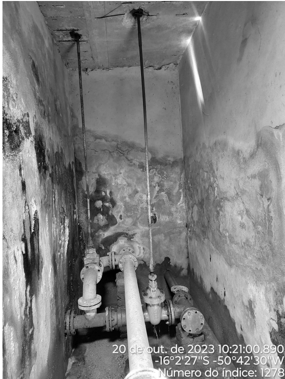
Foto 3 - Vazamento nos registros da galeria dos filtros
