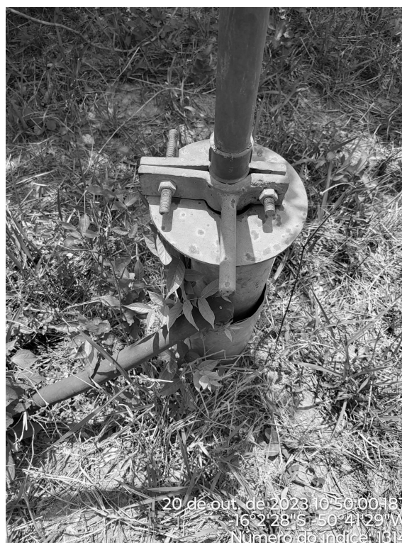
Foto 2 - Ausência de laje de proteção no Poço captação.
