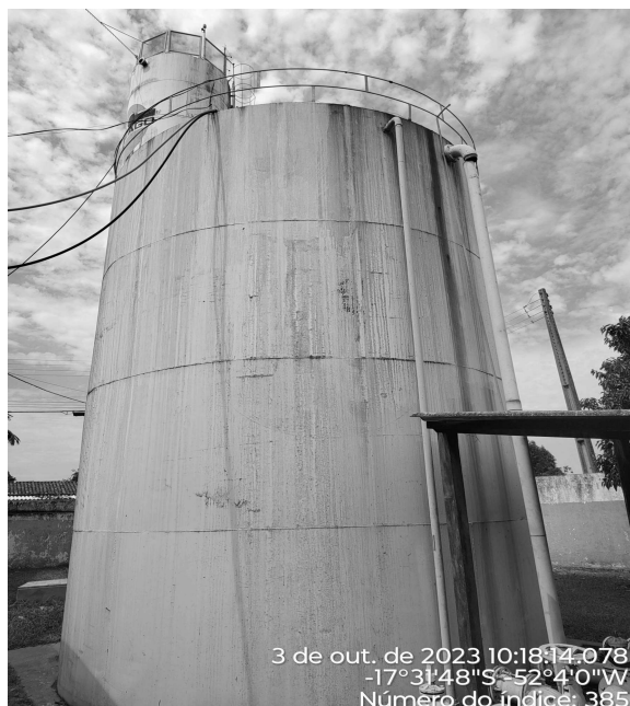
Foto 1 - RAP 100 m 3 com pintura desgastada.
