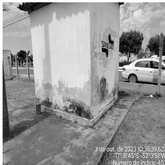
Foto 2 - Abrigo do quadro de comando do P1 com pintura desgastada.
