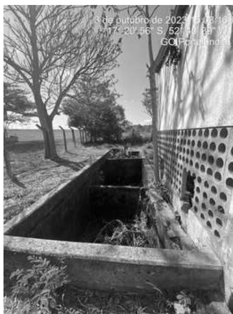
Foto 7 - Caixa de passagem com ausência de grade de proteção na área do Poço 2
