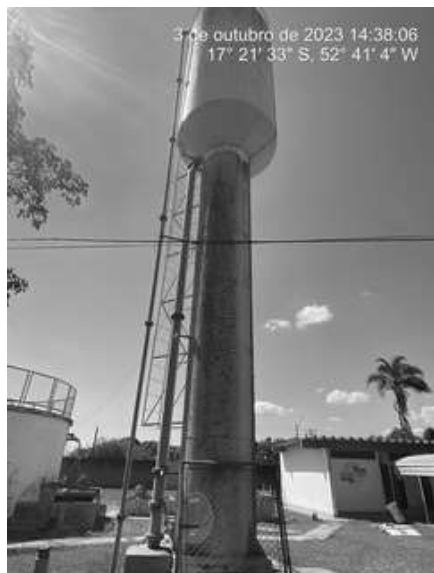
Foto 3 - REL Distrito com pintura desgasta
