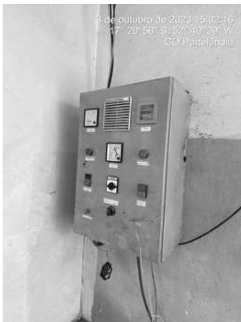
Foto 5 - Abrigo do quadro de comando do Poço P2 sem aviso de advertência
