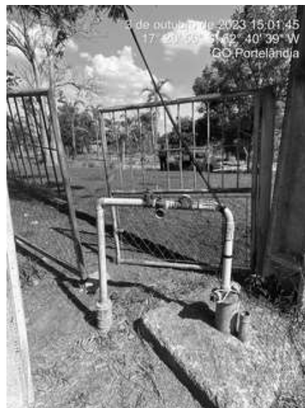
Foto 4 - Ausência de placa de identificação do Poço P2
