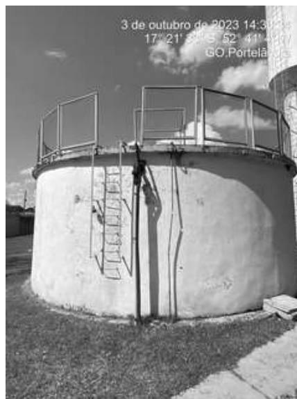
Foto 2 - RAP do Distrito com pintura desgasta e ausência de guarda-corpo na escada de acesso ao reservatório.
