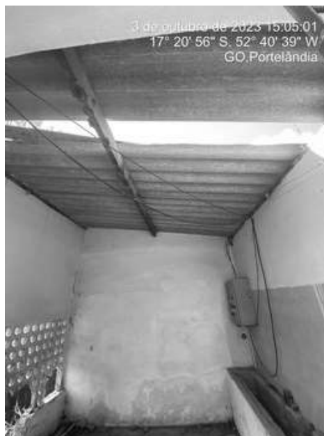
Foto 6 - Abrigo do quadro de comando do Poço P2 com telhados e paredes danificadas
