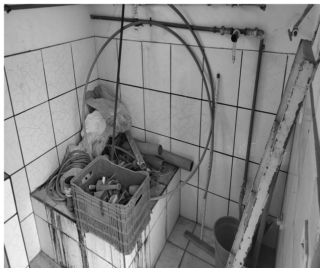
Foto 8 - Materiais diversos guardados e desorganizados dentro do abrigo do quadro de comando.
