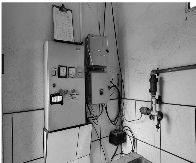
Foto 7 - Quadro de comando do Poço sem aviso de advertência.
