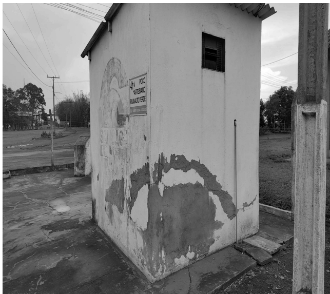
Foto 5 - Perda de revestimento e pintura desgastada no abrigo do quadro de comando do Poço.
