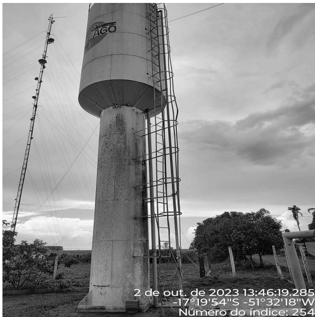
Foto 1 - REL com pintura desgastada.
