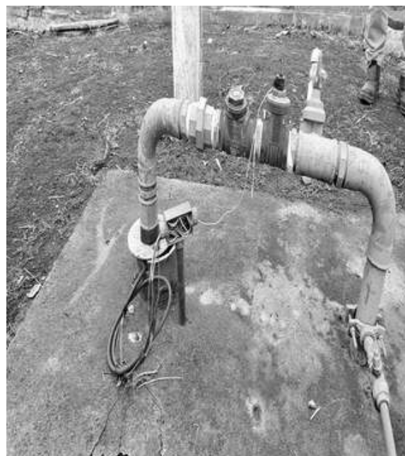
Foto 6 - Fiação exposta no Poço.
