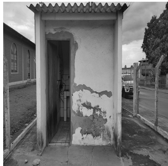
Foto 4 - Perda de revestimento e pintura desgastada no abrigo do quadro de comando do Poço.
