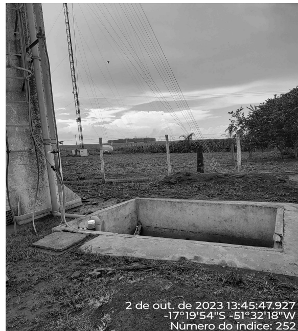
Foto 2 - Caixa de passagem com ausência de grade de proteção ou tampa na área do REL.
