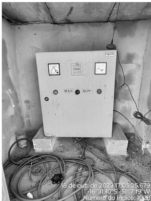
Foto 1 - Quadro de comando do poço 01 sem aviso de advertência na área de risco.
