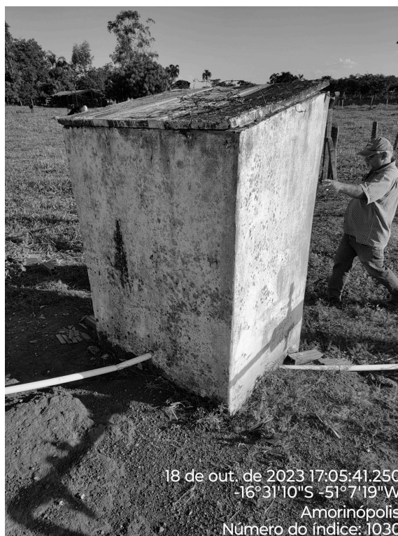
Foto 5 - Abrigo do quadro de comando do poço 01 com pintura desgastada.
