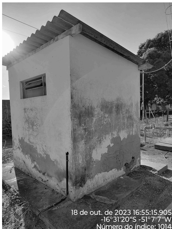
Foto 3 - Pintura desgastada e presença perda de revestimento na Casa de cloração (área do REL).
