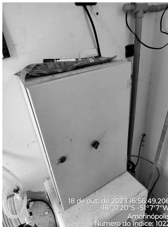
Foto 2 - Casa de cloração (área do REL) sem aviso de advertência na área de risco.
