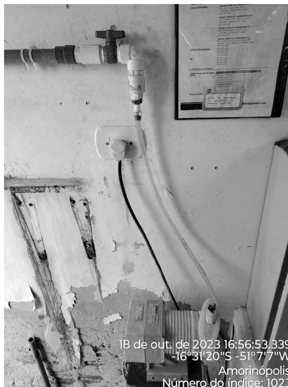
Foto 4 - Presença de perda de revestimento na Casa de cloração (área do REL).
